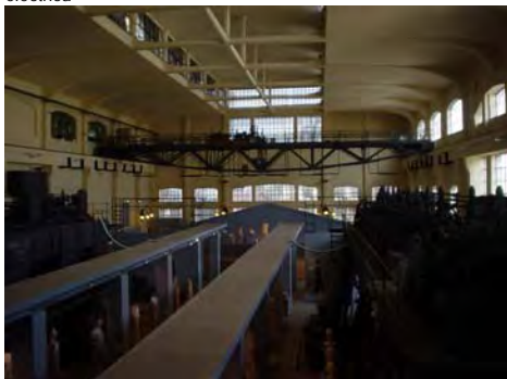
Imagen 6 de una de las salas de exposición donde se encuentran los motores de diesel
