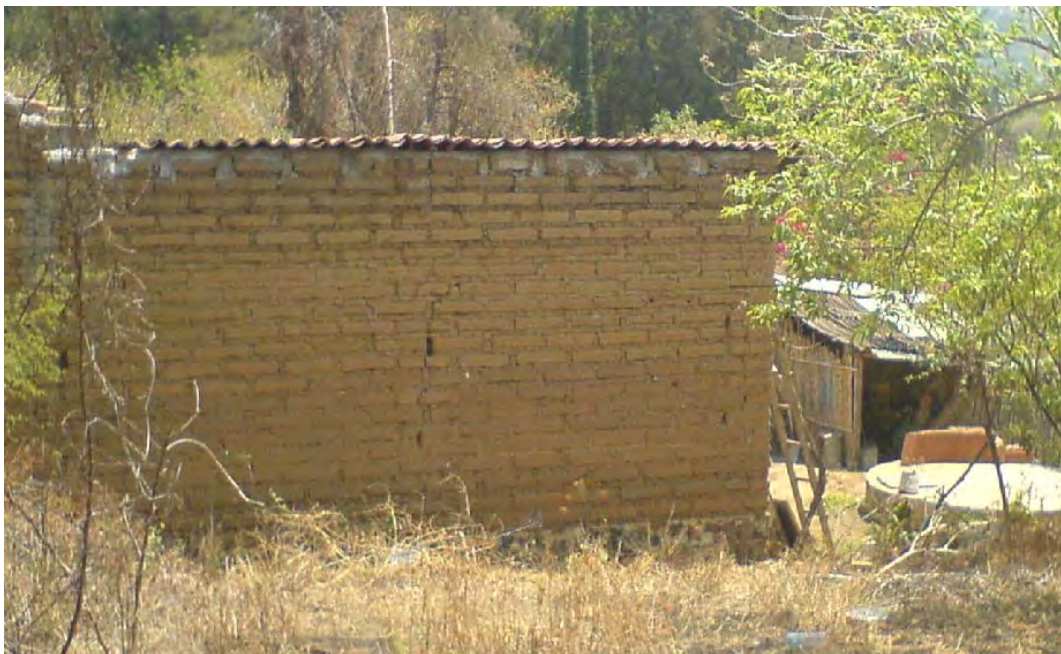
Fig. 23. Vivienda con muros de adobe sin aplanado y techo de lámina de asbesto
