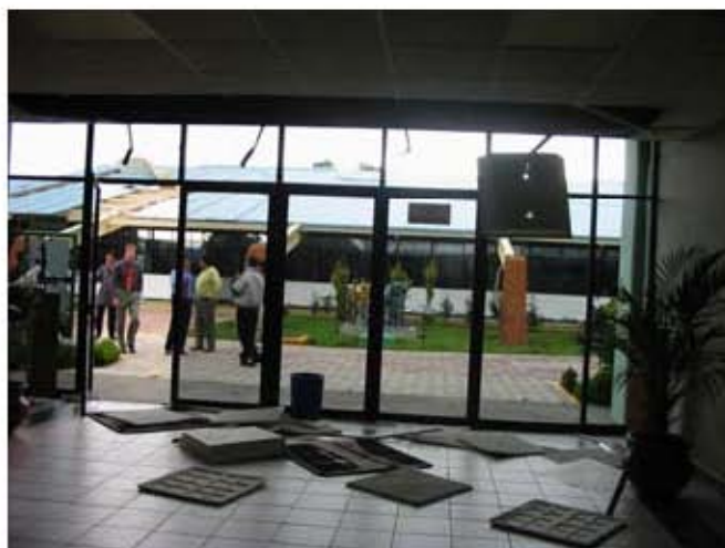
Foto N° 3.5. Cortesía de Daniel Ignacio. Ventanales desprendidos por el tornado en el edificio de Rectoría. En las oficinas que ocupa el rector una ventana completa de más de cuatro metros cuadrados fue arrancada por el viento.
