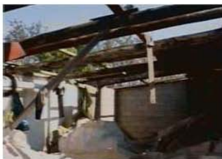
Foto N° 3.3. Daño ocasionado por el tornado, Mala Yerba. Tomada por TV azteca.
