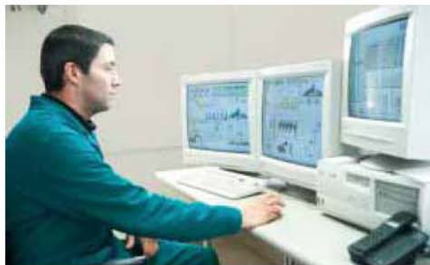
Fig. IV. 17 Parte del equipo de control de la planta.
