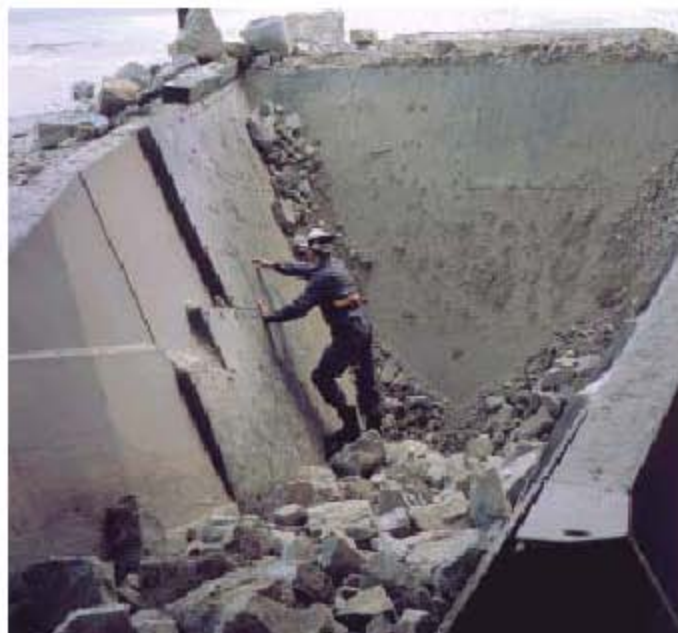
Fig. III.5 Material de protección a tolvas a base de polímeros.
