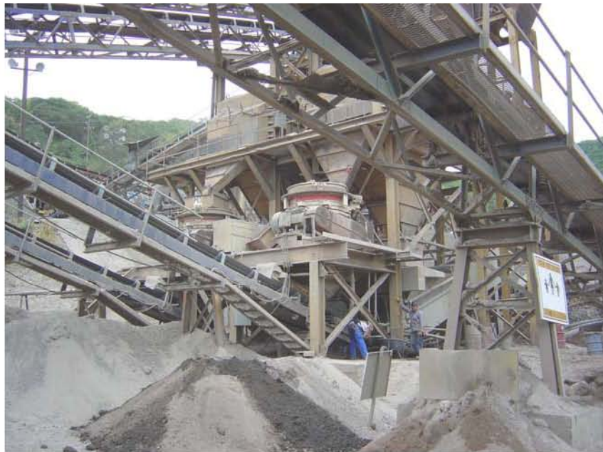
Fig. IV 15 Equipo de trituración terciario
