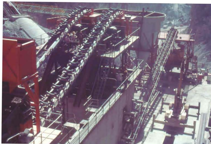
Fig. III.33 Bastidor de una banda transportadora
