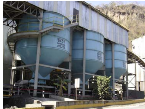
Foto 5: Silos de almacenamiento gránulos finos
