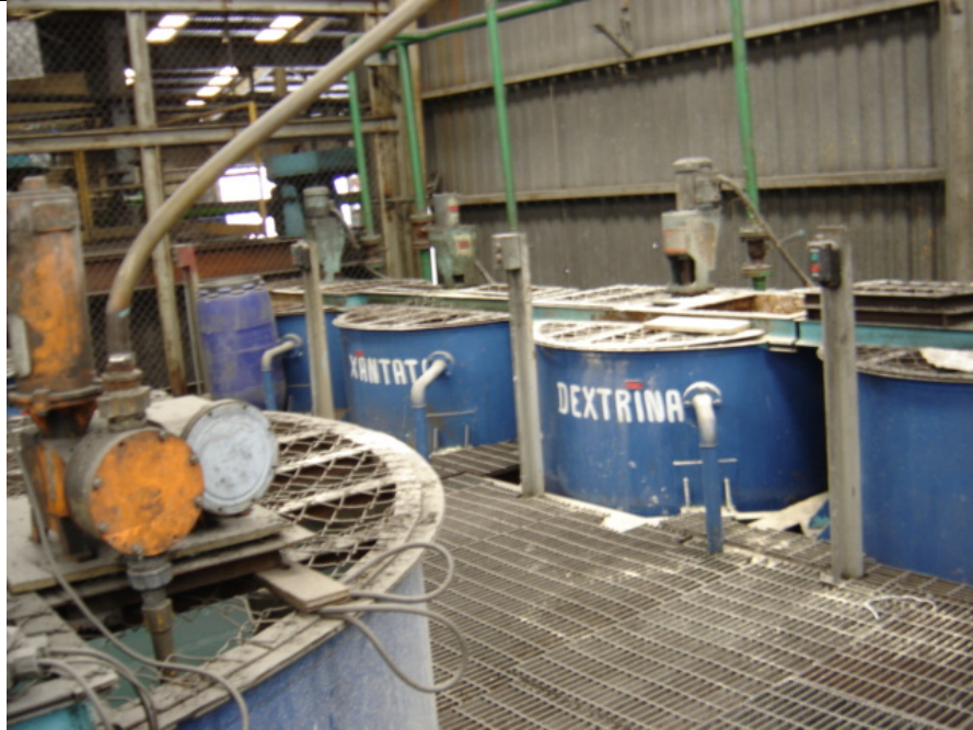
Foto 12: Tanques de acondicionamiento dextrina y xantato
