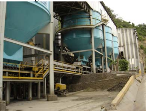
Foto 4: Silos de almacenamiento gránulos finos
