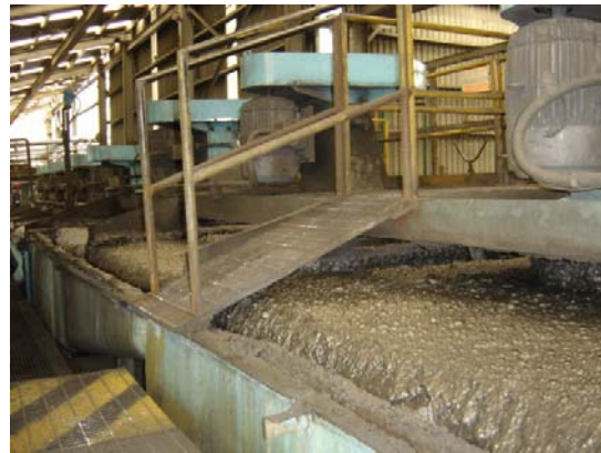
Foto 14: Circuito de flotación plomo-cobre
