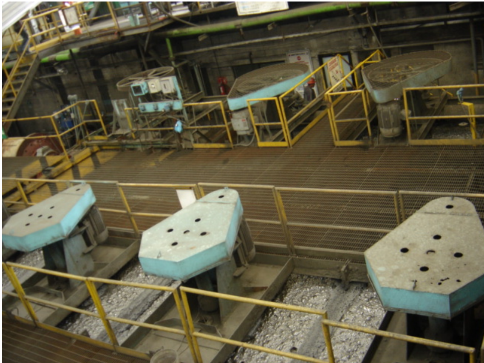
Foto 22: Circuito flotación zinc
