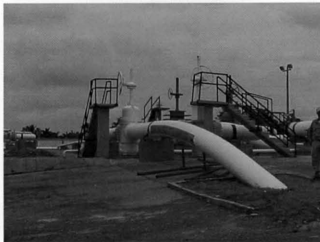
Figura 4.6 Válvula de seccionamiento tipo manual en los sistemas de poliductos.
