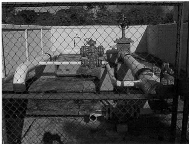
Figura 4.7 Trampa de recibo de diablos del poliducto de 12" D.N. Mina-Vhsa.
