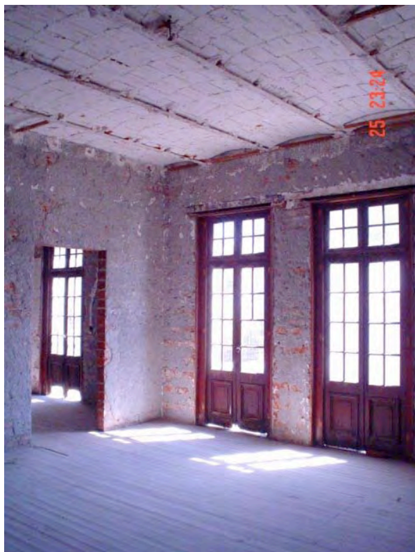
Fotografía 60: Habitaciones al oriente en primer piso. Se aprecia claramente el estado de la manguetería de las ventanas, en algunos casos faltan piezas, en otros la madera presenta graves casos de putrefacción y apolillamiento, así como falta de vidrios. Fotografía tomada in situ año 2004.
