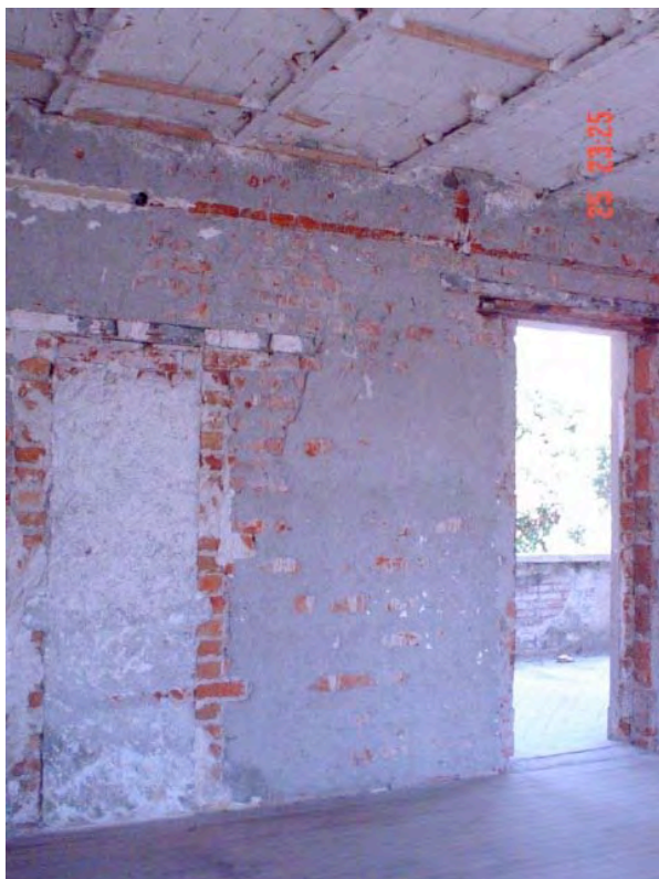
Fotografía 65: Habitaciones al oriente en primer piso, vano tapiado y oquedades en recubrimientos de los muros, falta de puerta, plafón y cornisas. Fotografía tomada in situ año 2004.
