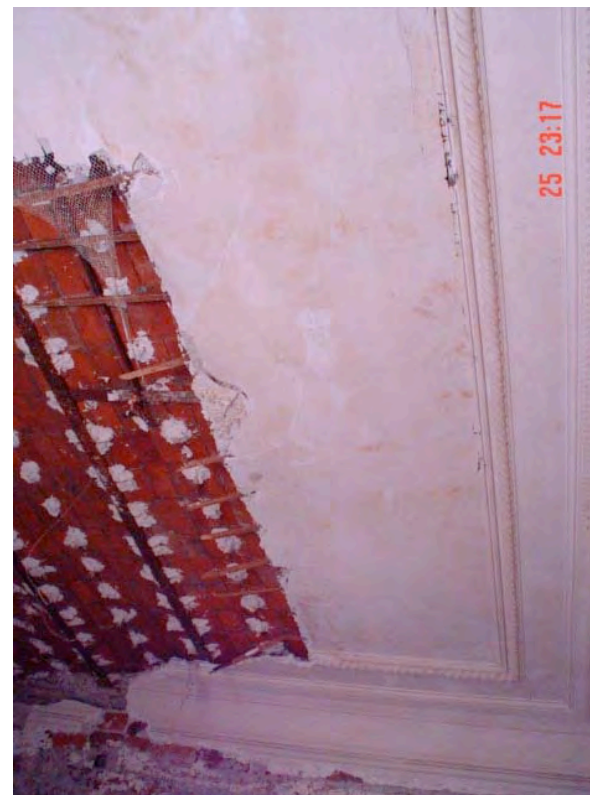
Fotografía 41: Habitación poniente. Esta habitación presenta daños en plafón y en cornisas, obsérvese el sistema estructural de la habitación a base de bóveda catalana. Fotografía tomada in situ año 2004.
