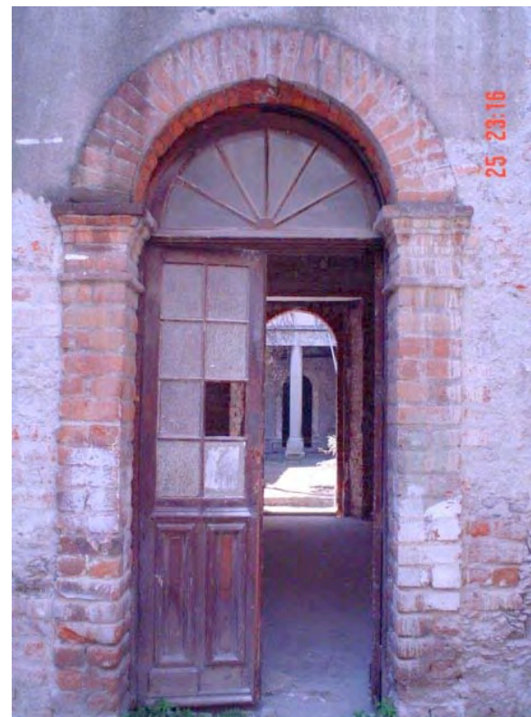
Fotografía 36: Detalle puerta de acceso a una de las habitaciones. Debe considerarse el enmarcamiento formado por un arco de medio punto hecho con tabique desde su arranque, además del deterioro del aplanado en muro y el de la puerta de madera por el intemperismo y la falta de mantenimiento. Fotografía tomada in situ año 2004.
