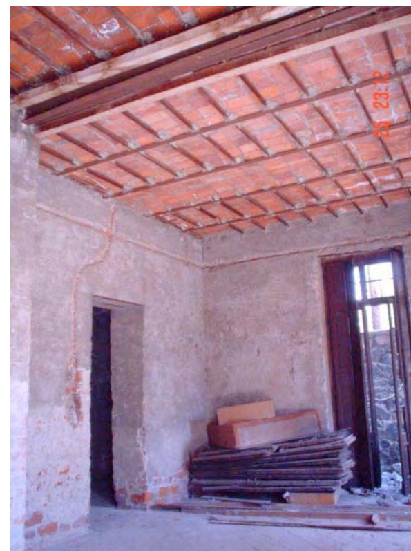
Fotografía 25: Vista general de una de las habitaciones del lado sur. Considérese la falta de aplanados y recubrimientos así como de plafón y el sistema constructivo utilizado, asimismo el sistema de manguetería de madera en las ventanas y en las puertas. Fotografía tomada in situ año 2004.
