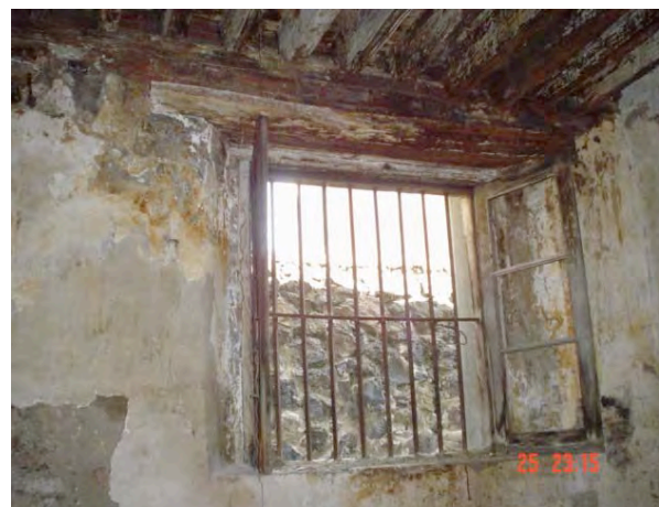
Fotografía 32: Detalle de la ventana de una de las habitaciones del lado noreste. Tomar en cuenta el deterioro en la ventana y en la vigería de madera, la cual se encuentra apoyada sobre una gualdra de madera. Obsérvese la herrería original que no existe en ninguna otra ventana. Fotografía tomada in situ año 2004.
