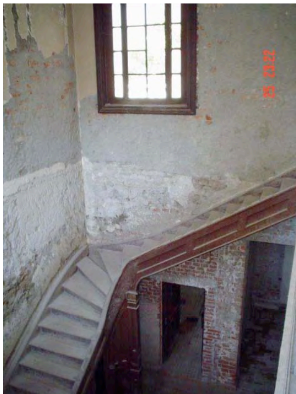
Fotografía 56: Vista parcial de las escaleras desde el primer piso, apreciándose un baño debajo de las escaleras de construcción reciente, a sus muros les falta recubrimiento, también se puede apreciar la falta de pretil de las escaleras y algunas huellas rotas. Fotografía tomada in situ año 2004.
