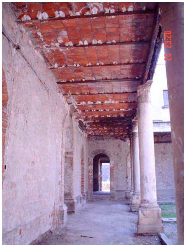
Fotografía 20: Vista del pasillo y de la cubierta del mismo pasillo en planta baja. Obsérvese que los muros no cuentan con aplanado, el cual, como puede apreciarse, fue retirado y podemos inferir que esto se llevo a cabo en una época reciente. Fotografía tomada in situ año 2004.
