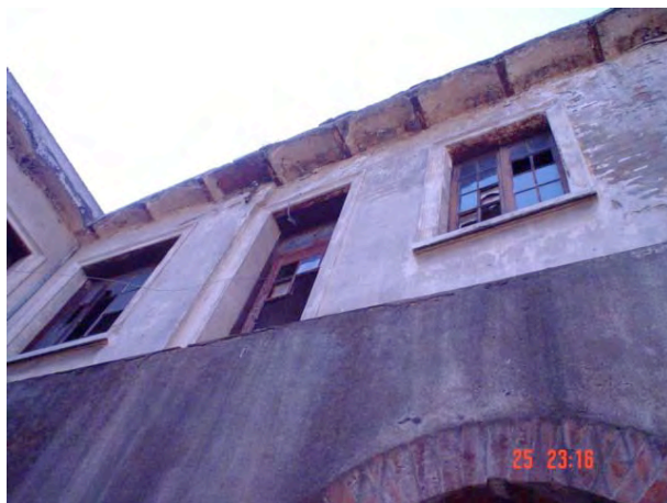
Fotografía 37: Patio secundario. Nótese el desgaste de los recubrimientos de la losa, vidrios rotos y el estado de la manguetería, además de falta de recubrimiento de los muros debido a la falta de mantenimiento y a la presencia de humedad. Fotografía tomada in situ año 2004.
