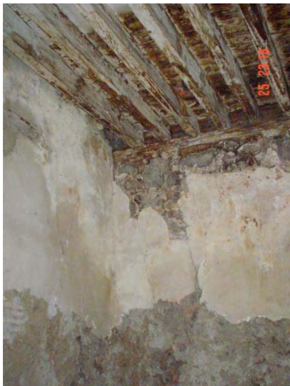
Fotografía 33: Detalle del deterioro del muro de material compuesto de una de las habitaciones del lado noreste debido a la humedad y al desprendimiento de aplanado. Fotografía tomada in situ año 2004.
