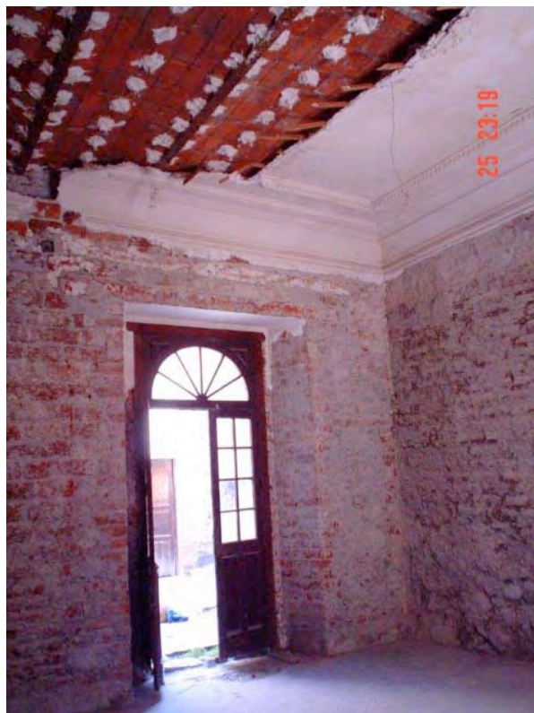
Fotografía 40: Habitación poniente, falta total de recubrimiento de muros, manguetería en mal estado y falta de vidrios. Fotografía tomada in situ año 2004.
