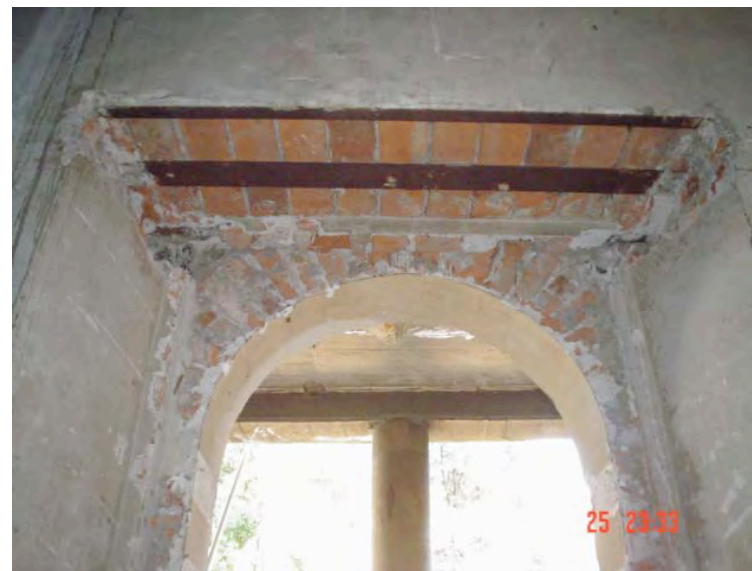
Fotografía 49: Vano que comunica el recibidor con el patio central. En esta foto se aprecia la falta de recubrimientos del arco y del muro del arco, al fondo se aprecia el estado de corrosión de una de las vigas de acero que funcionan como sistema estructural del corredor, su falta de recubrimiento y la ausencia de plafón. Fotografía tomada in situ año 2004.
