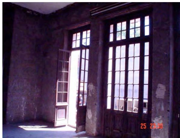
Fotografía 46: Habitaciones al poniente. Falta de terminado en los muros, además que los muros cuentan con perforaciones, falta de cornisa, ausencia de vidrios en ventana, y deterioro de la manguetería de las ventanas. Fotografía tomada in situ año 2004.
