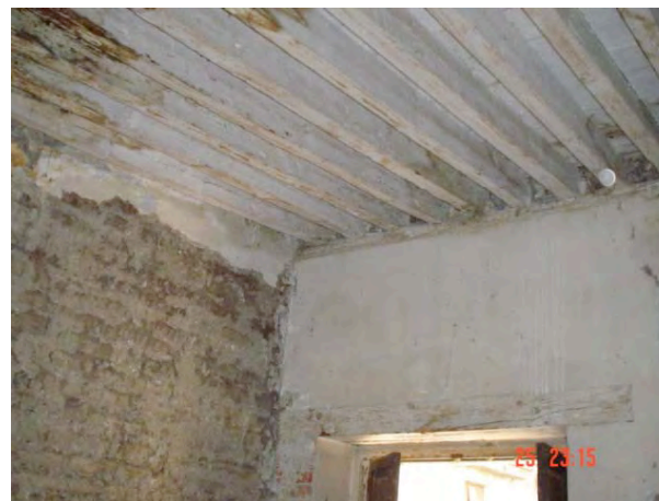
Fotografía 31: Detalle de la vigería de madera y el muro de material compuesto en una de las habitaciones del lado noreste. Los materiales presentan un gran deterioro debido a la humedad que ha provocado desprendimiento de aplanados en muro y deterioro en la vigería de madera, de seguir así esto puede ser causante de deterioro estructural. Fotografía tomada in situ año 2004.
