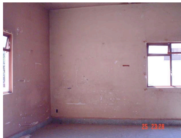
Fotografía 72: Habitación al sur en primer piso. Cuenta con zoclo y piso de granito, herrería de manufactura reciente. Presenta algunos daños en el recubrimiento de los muros. Fotografía tomada in situ año 2004.
