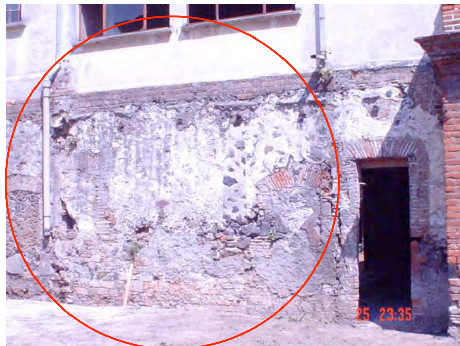
Fotografía 13: Detalle de la fachada norte en planta baja. Obsérvense los tres vanos tapiados (enmarcados en un círculo rojo) enmarcados por arcos escarzanos cuyas dovelas están formadas por ladrillo de barro cocido. Debe considerarse que este muro corresponde a una de las partes más antiguas de la casa. (Ver fig. 51, plano de épocas constructivas planta baja). Fotografía tomada in situ 2004.
