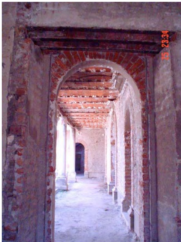
Fotografía 22: Vista del arco de acceso a una de las habitaciones del lado norte. Obsérvese el refuerzo mediante viguetas de acero sobrepuestas en el tabique de barro cocido además de la falta de recubrimiento a lo largo de todo el pasillo y en el acceso. Fotografía tomada in situ año 2004.
