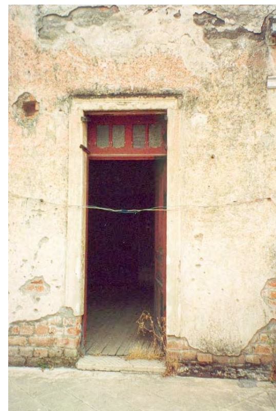
Fotografía 39: Patio secundario y acceso a una de las habitaciones de lado norte, Falta de recubrimientos en los muros, presencia de vegetación parásita, también es de destacar el estado de la duela en la habitación, y una gran presencia de humedad en los muros, que en algunas secciones están hechos de adobe, y una oquedad en ladrillos. Fotografía tomada in situ año 2000.
