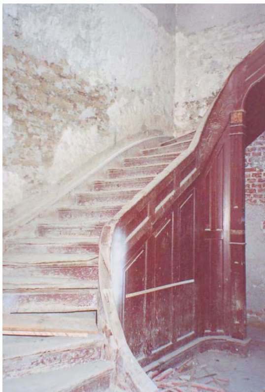
Fotografía 54: Escalera. El estado de conservación de la escalera es bueno, a excepción del desgaste que presentan las huellas de la escalera llegando al grado en algunos casos de ausencia de las mismas. Fotografía tomada in situ año 2004.
