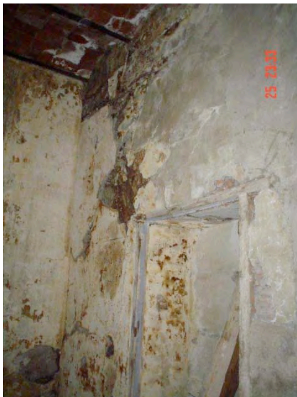
Fotografía 52: Habitación sur. En esta foto detectamos presencia de salitre además de desprendimiento de los recubrimientos de los muros y lo que es más preocupante es el flambeo del dintel del vano. Fotografía tomada in situ año 2004.
