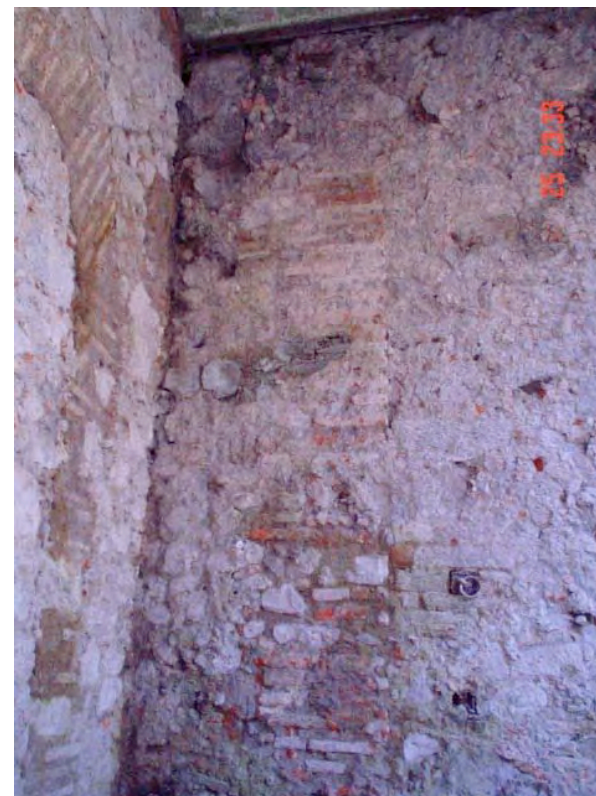
Fotografía 53: Flambeo de los muro de la habitación sur. Además del flambeo con esta foto demostramos las diferentes épocas constructivas que han tenido lugar en el inmueble, obsérvense los diferentes materiales que hay en los muros. Fotografía tomada in situ año 2004.
