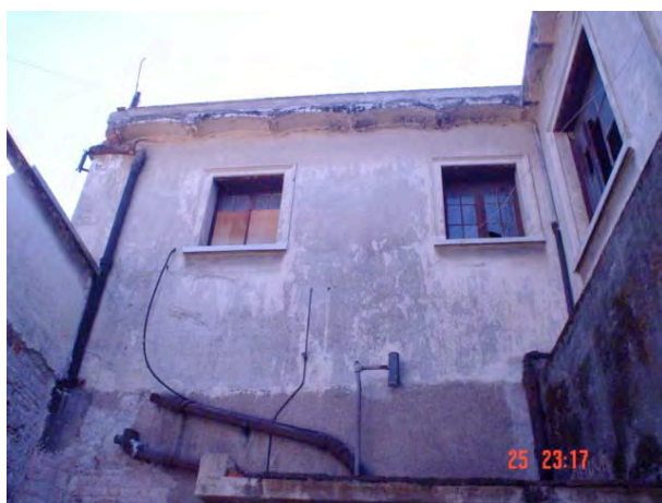
Fotografía 38: Patio secundario. Corrosión y falta de piezas en tubo de hierro fundido, desprendimiento de aplados, vegetación parásita y humedad en los muros, vidrios rotos y manguetería de madera en mal estado. Fotografía tomada in situ año 2004.
