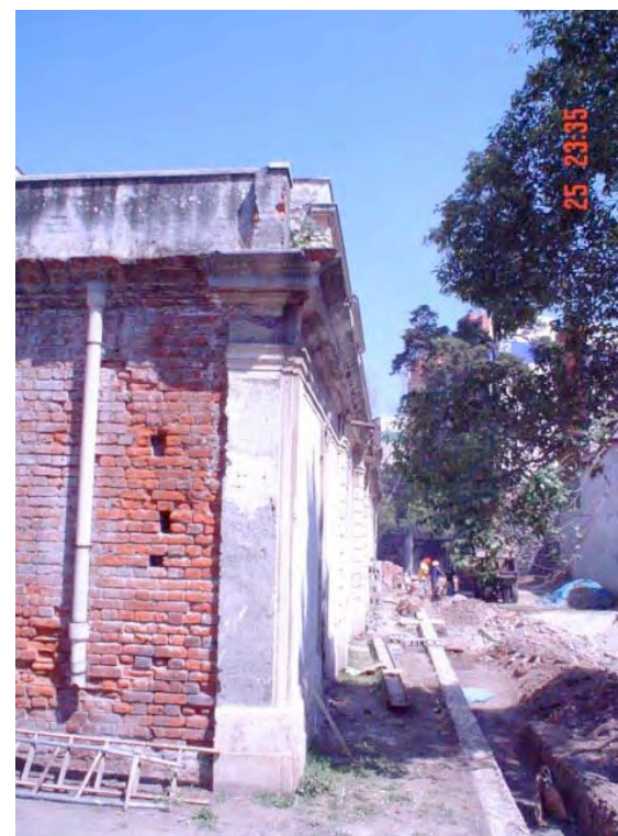
Fotografía 11: Perfil de la fachada oeste, donde se observa un desprendimiento del aplanado ocurrido probablemente en una época reciente. Fotografía tomada in situ año 2004.
