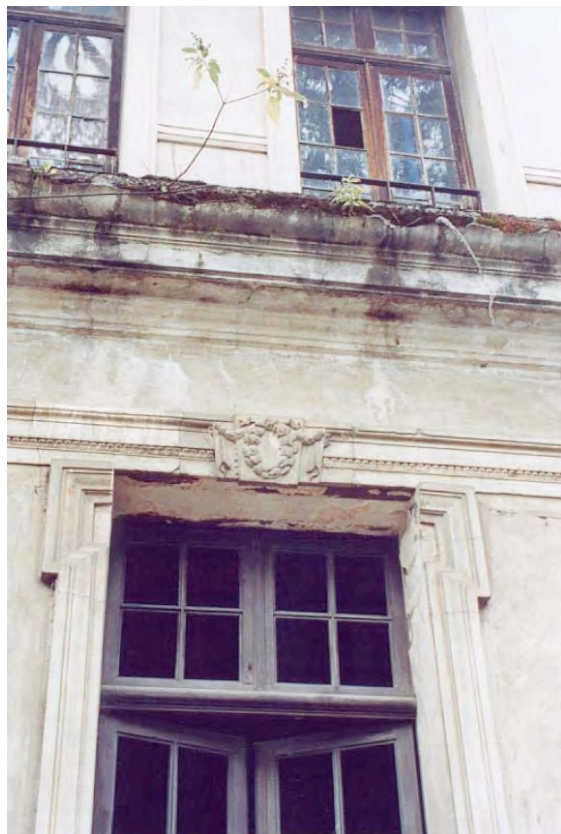
Fotografía 6: Detalle de la ventanería en planta baja y en planta alta. Obsérvese la vegetación parásita en la cornisa que divide la planta baja y el primer piso. Fotografía tomada in situ año 2000.
