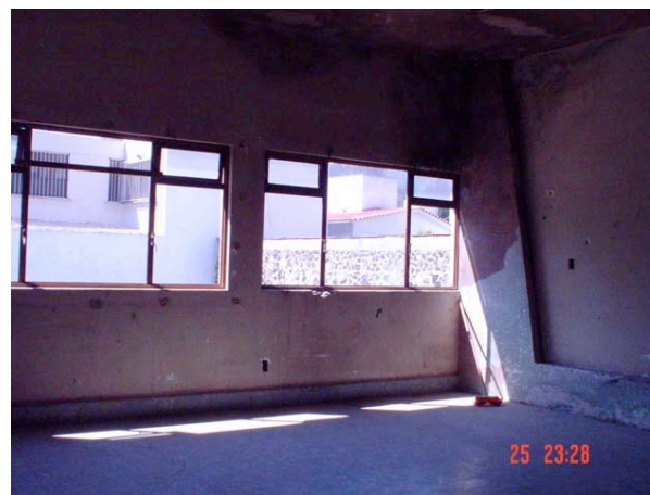
Fotografía 71. Habitación al sur en primer piso. Esta es la habitación de construcción más reciente, podemos apreciar una gran presencia de humedad tanto en su losa como en los muros, algunas oquedades en el muro a la altura del marco de la ventana. Fotografía tomada in situ año 2004.
