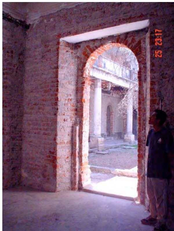
Fotografía 42: Vista interior del acceso que comunica la habitación poniente con el patio principal. Obsérvese la falta de puerta, de recubrimiento de muros, del derrame y del enmarcamiento, además del firme de cemento. Fotografía tomada in situ año 2004.
