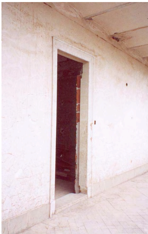
Fotografía 67: Vano de acceso a la habitación al sur en primer piso, se aprecia humedad y vegetación parásita en el recubrimiento de la bóveda catalana. Fotografía tomada in situ año 2000.
