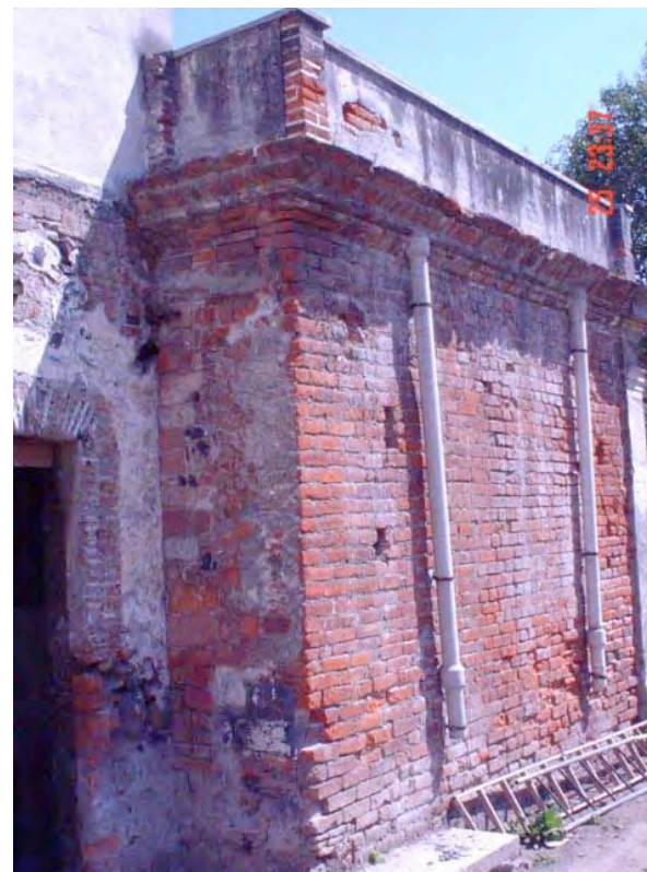
Fotografía 15: Detalle del muro, pretil (de fabricación posterior) y cornisa de tabique de barro. Considérese el deterioro de los elementos debido al intemperismo y al desprendimiento de aplanado del que fue objeto. Fotografía tomada in situ 2004.
