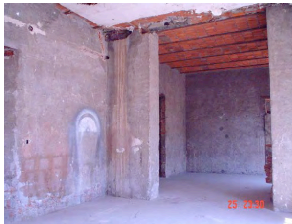
Fotografía 47: Habitaciones al poniente. En esta fotografía podemos apreciar falta de piezas en la bóveda catalana, filtraciones de agua y oquedades en el muro, además de falta de materiales en la unión entre la losa y el muro. Fotografía tomada in situ año 2004.
