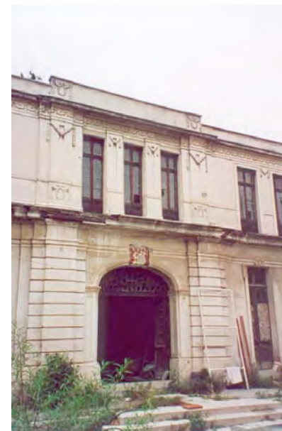
Fotografía 4: Detalle del acceso en planta baja y la parte superior que tenía funciones de habitación. Considerar el deterioro que ha sufrido el inmueble debido al intemperismo, y a la falta de mantenimiento. Fotografía tomada in situ año 2000.
