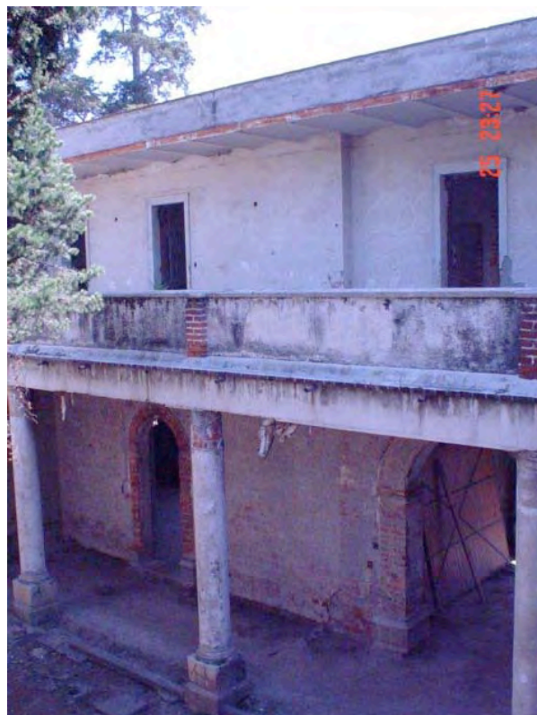
Fotografía 70: Vista parcial del acceso principal desde el primer piso, se aprecia claramente la falta de piso en el corredor y área de acceso, deterioro en los recubrimientos fuste de la columna, humedades en el pretil del pasillo del primer piso. Fotografía tomada in situ año 2004.
