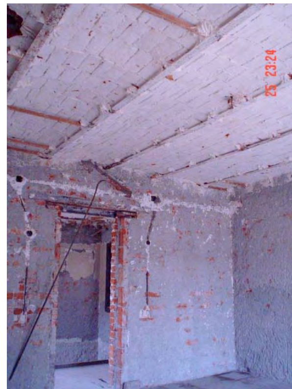
Fotografía 59: Habitaciones ponientes del primer piso. Vista de las oquedades y discontinuidades en los recubrimientos de los muros de las habitaciones. Se aprecian parte de las instalaciones eléctricas, las cuales son de fabricación reciente pero están en muy mal estado. Fotografía tomada in situ año 2004
