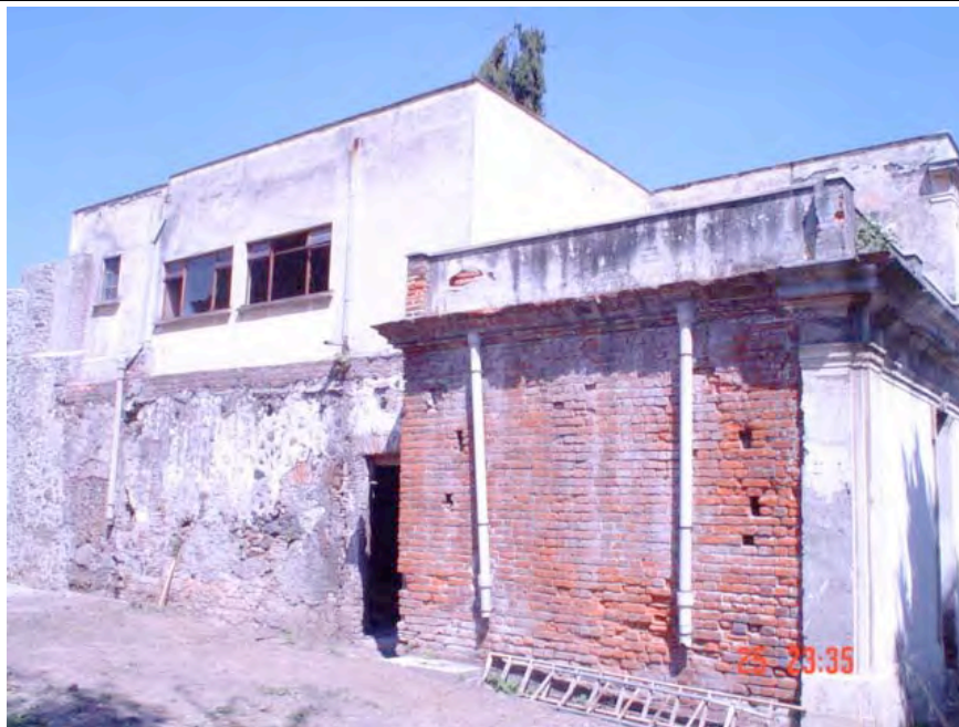
Fotografía 10: Vista general de una de las fachadas laterales (fachada norte). Detalle de la terraza y de la planta en primer piso en donde se observa una diferencia de los materiales y de la composición y forma de la ventanería. Puede observarse que el aplanado de la fachada oeste ya no continuó y fue desprendido en un período posterior. Fotografía tomada in situ año 2004.
