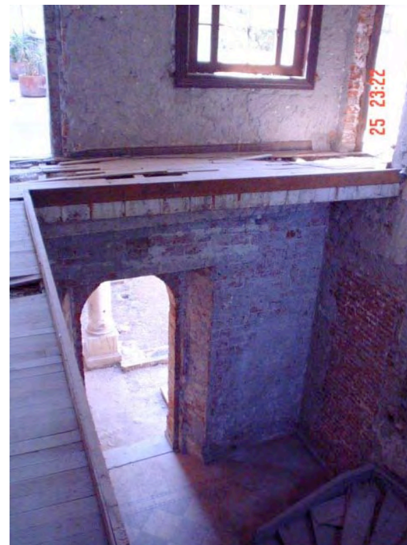
Fotografía 57: Cubo de las escaleras. Podemos apreciar el estado de la duela y la falta de pretil del pasillo que comunica al pasillo principal con las habitaciones del poniente. Fotografía tomada in situ año 2004.
