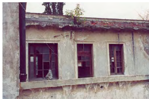
Fotografía 69: Fachada de las habitaciones norte y cubo de la escalera. Claramente podemos apreciar grandes áreas de humedad en los muros, falta de vidrios en las ventanas, falta de recubrimiento en el pretil de la azotea y vegetación parásita en el mismo. Fotografía tomada in situ año 2000.
