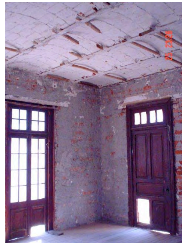
Fotografía 64: Ventana de una de las habitaciones al oriente y puerta de acceso al balcón. La falta de piezas es constante en la maguetería del primer piso. Fotografía tomada in situ año 2004.
