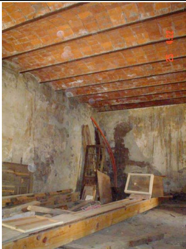
Fotografía 24: Vista general de una de las habitaciones en el lado norte, obsérvese el sistema constructivo en las losas y el deterioro de los aplanados en los muros debido a la humedad. Fotografía tomada in situ año 2004.
