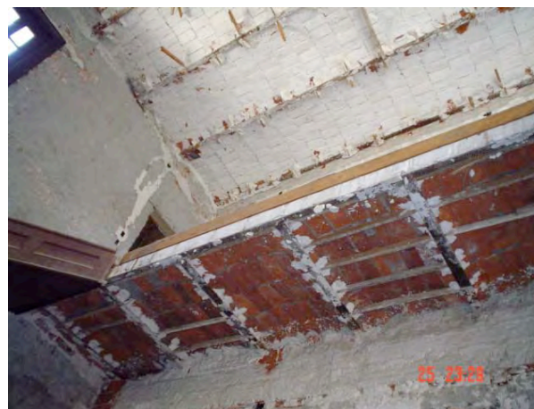
Fotografía 62: Pasillo principal del cubo de las visto desde la planta principal se aprecia la falta de plafón tanto en la losa del pasillo como en la losa del cubo de las escaleras. Fotografía tomada in situ año 2004.
