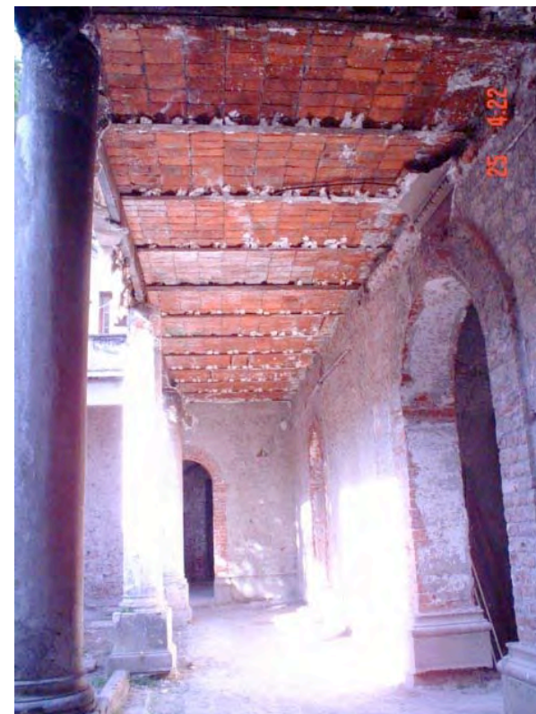
Fotografía 17: Pasillo en planta baja; en el que pueden verse los accesos a las habitaciones enmarcadas por arcos de medio punto elaborado con tabiques de barro cocido. Obsérvese también la losa de entrepiso en sistema de bóveda catalana hecha con vigueta I de acero y semicaños de ladrillo. Deben notarse los restos de plafond de yeso sobre tela de gallinero (el cual en el año 2000 todavía existía aunque estaba desprendiéndose debido a la humedad). Fotografía tomada in situ año 2004.
