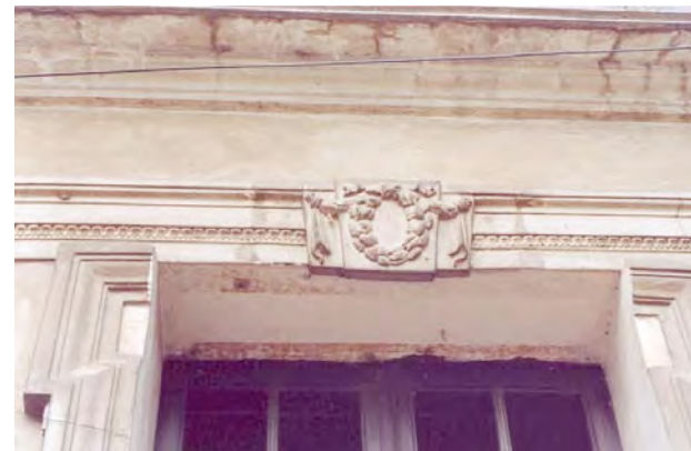
Fotografía 7: Detalle de cornisa en uno de los vanos en planta baja del inmueble. Considerar el deterioro que ha sufrido el inmueble debido al intemperismo, y a la falta de mantenimiento. Fotografía tomada in situ año 2000.
