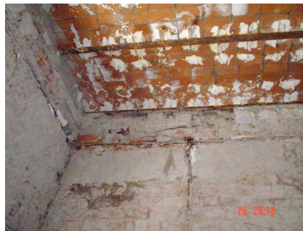
Fotografía 43: Habitación poniente. Otra vista del estado de esta habitación, denotando corrosión en la estructura de la bóveda catalana, falta de recubrimientos en los muros, ausencia de plafón y cornisas. Fotografía tomada in situ año 2004.
