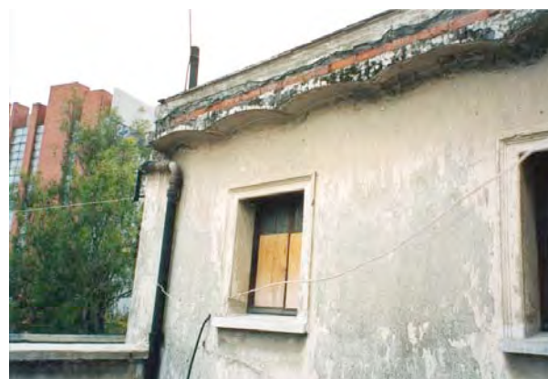
Fotografía 68: Fachada de las habitaciones poniente. Puede apreciarse la falta de recubrimientos y la composición de la losa de azotea, así como el deterioro que ha sufrido por humedades, lo que ha provocado el reblandecimiento de la propia losa. Fotografía tomada in situ año 2000.
