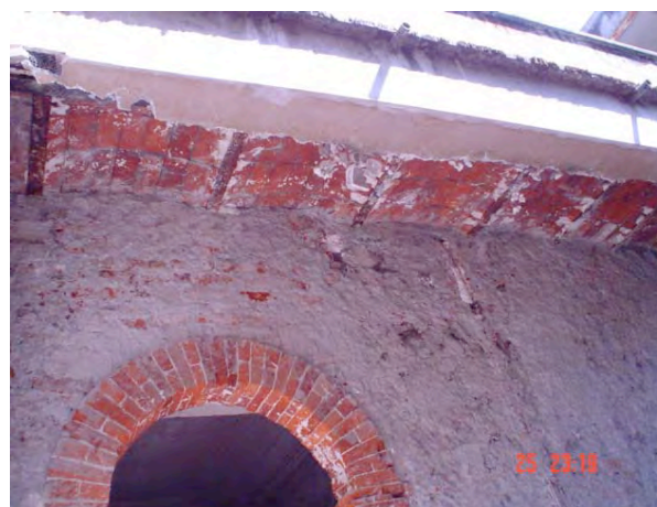
Fotografía 44: Vista de la puerta que comunica la habitación poniente con el patio principal. Obsérvese la falta de puerta, de recubrimiento de muros y la ausencia de plafón del corredor del segundo piso. Fotografía tomada in situ año 2004.
