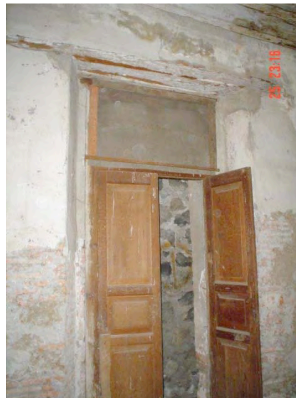
Fotografía 34: Detalle de puerta de comunicación a uno de los pasillos (el cual se generó posteriormente como podrá verse en el capítulo de anexos). Considérese el deterioro en muro y en el cerramiento debido al desprendimiento de aplanados. Fotografía tomada in situ año 2004.
