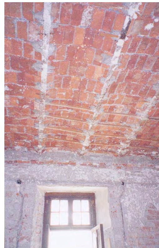
Fotografía 55: Ventana del cubo de las escaleras. Faltan los recubrimientos de los muros, el plafón y la cornisa. Fotografía tomada in situ año 2004.
