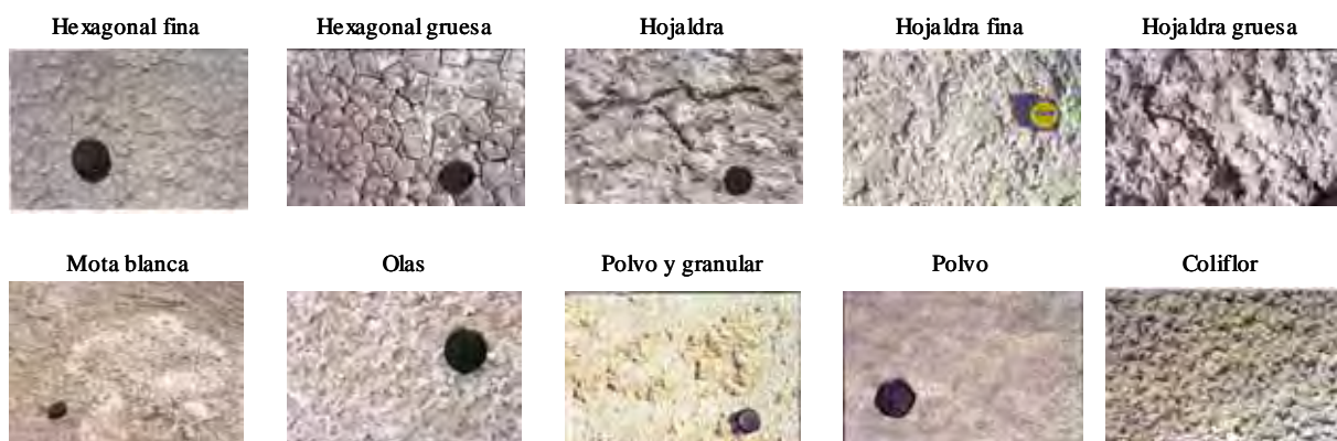
Figura 7.1.10.- Aspecto general de las costras superficiales identificadas.
