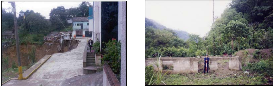
Figura 1.10 Daños en calles y casas habitación por procesos de remoción en masa. En la imagen izquierda se aprecian los daños en la vía de comunicación, pero el avance del circo de erosión puede alcanzar las construcciones cercanas (Zacapoaxtla; foto: Secretaría de Protección Civil de Puebla); la imagen derecha muestra una vivienda cubierta por material removido, misma que ha sido abandonada, aunque probablemente sea por un período corto de tiempo (Zapotitlán de Méndez; foto del autor).
