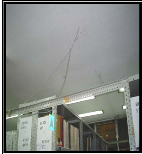
Fotografía 23 En esta fotografía se puede observar cable UTP CAT. 5 colgando del techo al área de estantes se puede observar que en la parte de atrás existió una canalización que muy probablemente se despegó con el tiempo o la quitaron por las constantes remodelaciones
