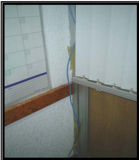
Fotografía 24 En esta fotografía se puede observar como baja el cableado de UTP CAT 5E y solamente va sujeto con cinta canela lo cual no lo hace seguro ni administrable ya que llega directamente a la computadora y no a un nodo de salida
