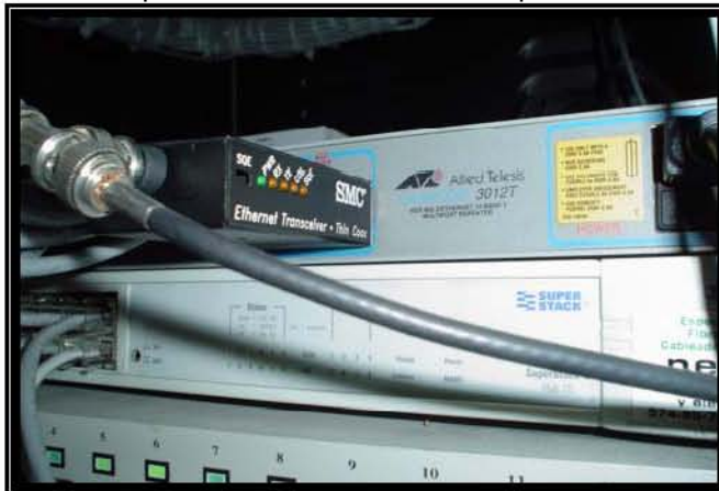
Fotografía 1 En esta fotografía se observan los equipos que sustentan la topología de bus que da servicio a otros pisos del edificio.
