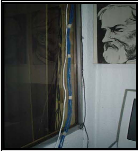
Fotografía 22 En esta fotografía se puede observar un mazo de cables UTP CAT 5E que vienen del Closet de Telecomunicaciones y llegan directamente a las tarjetas NIC de algunas computadoras y no pasan por algún nodo de datos.
