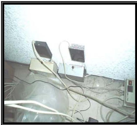
Fotografía 29 En esta fotografía se observa la salida de voz que alimenta a toda la biblioteca con 4 extensiones telefónicas (dispositivos secretariales), además se puede observar cables eléctricos que pasan cerca de los equipos y no están a 12cm mínimos de distancia para que no causen interferencia sobre los dispositivos secretariales.
