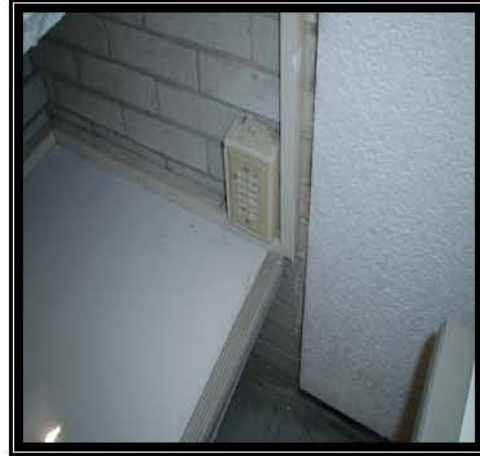
Fotografía 19 Esta Fotografía muestra una caja de comunicaciones con 6 salidas de red, las cuales alimentaban al área de consulta pero con la reubicación estos nodos han quedado ocultos.
