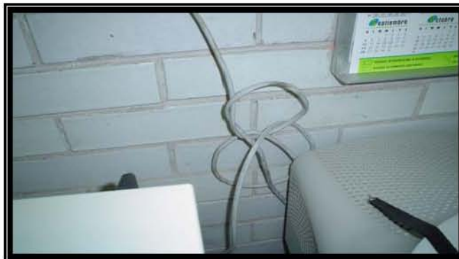
Fotografía 27 En esta fotografía se puede observar como dentro de un cubículo esta el cable UTP CAT 5 hecho nudo en algunas partes y otras se observa que esta muy doblado esto puede crear demasiadas contingencias de red.
