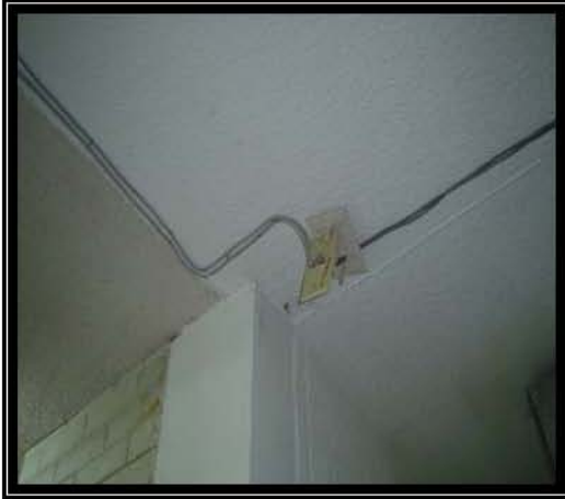
Fotografía 18 En esta fotografía se puede observar un nodo de red en el techo de falso plafón, el cual se encuentra a punto de caer y no esta canalizado solo se encuentra engrapado lo cual puede cortar algunos hilos de UTP por la presión ejercida en el mismo.
