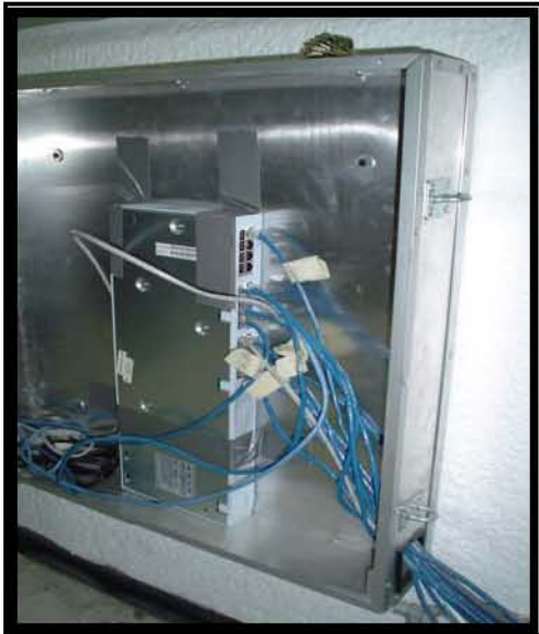
Fotografía 27 En esta fotografía se puede observar dentro de un registro un hub 3COM para potenciar la señal y distribuir más servicios de red esto puede crear demasiadas contingencias de red, no esta bien sujeto y los UTP's no se encuentran arreglados con cinturones.
