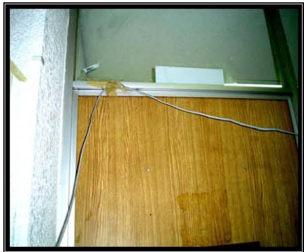
Fotografía 8 En esta foto se puede observar cable UTP C5, sujetado en el marco de la puerta de oficina de administrativos por cinta canela, según el cableado horizontal debe de ir por el piso o por el techo del edificio y los puntos de conexión de datos deben de estar conectados al panel de parcheo y en el otro extremo a un face place bien etiquetado, lo cual no es así.
