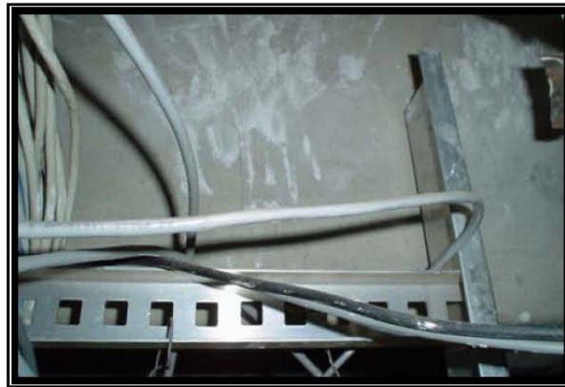
Fotografía 4 Conjunto de fotografías que muestran la Escalerilla con el Backbone del edificio y la tubería del horizontal.
