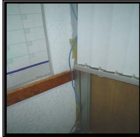
Fotografía 10 En esta fotografía se puede observar como baja el cableado de UTP CAT 5E y solamente va sujeto con cinta canela lo cual no lo hace seguro ni administrable ya que llega directamente a la computadora y no a un nodo de salida
