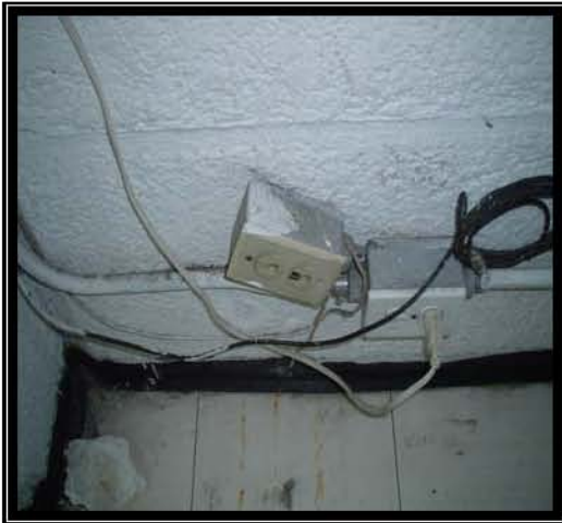
Fotografía 13 En esta fotografía se puede observar un nodo de voz enredado en una tubería de energía eléctrica además hay cables eléctricos de algún otro equipo electrónico así como una extensión de cable telefónico todos estos enredados en la tubería.
