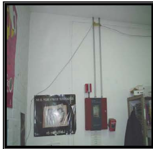
Fotografía 16 En esta fotografía es del área de préstamos, donde se observa cableado de UTP que va por la pared sujetado con cinta canela a una tubería muy probablemente de energía eléctrica.
