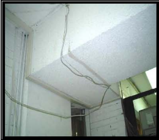
Fotografía 9 En esta fotografía se puede apreciar la entrada de la biblioteca y el cableado que se realizó para colocar otra computadora en red para la consulta al sistema de prestamos, se tiene diferente categoría de cable UTP además que no se encuentran ni canalizado ni bien sujeto al techo.
