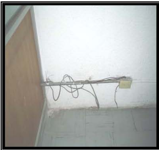
Fotografía 15 En esta fotografía se puede observar cable UTP CAT 5 enredado en una tubería de energía eléctrica así como parte de una extensión de energía eléctrica con las puntas sin aislar en la misma instalación Eléctrica, esto no solo va en contra de los estándares de comunicaciones sino de
