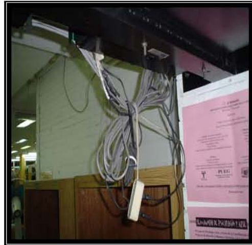
Fotografía 14 En esta fotografía se observa el cable UTP CAT 5 enredado con una extensión de energía eléctrica y otros cables de alimentación de energía eléctrica
