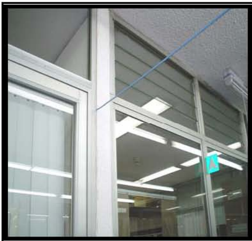
Fotografía 11 En esta fotografía se puede observar UTP CAT 5E que venía del área de estantes el cable no solo no esta canalizado sino que va volado a casi 1.80m tomando en cuenta la altura de la puerta del cubículo.
