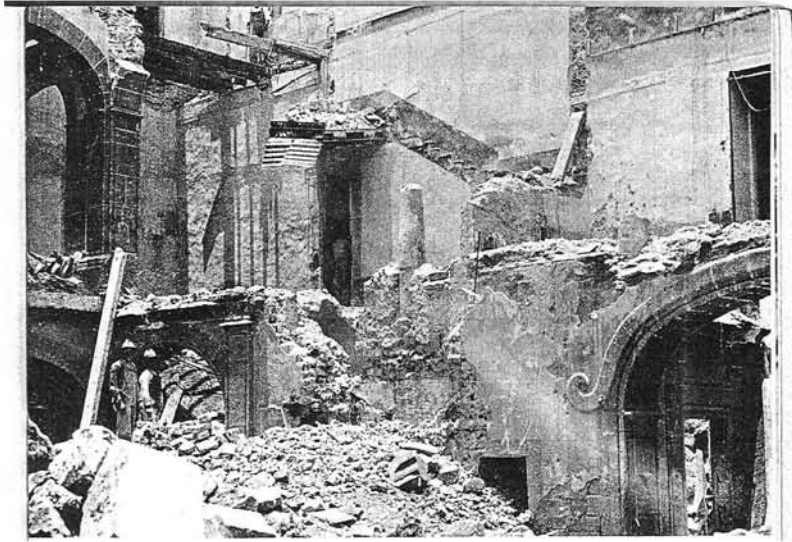
Figura 9. Aspecto de la demolición del edificio donde se ubicó el Hospital Real de Naturales. (Tomado de Venegas, 1973)
