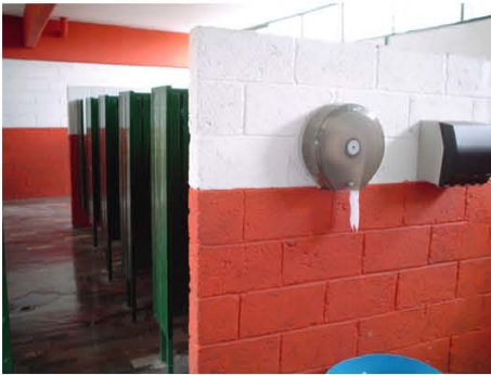
En los sanitarios no existe un cambio de material en los muros que los proteja de la humedad
