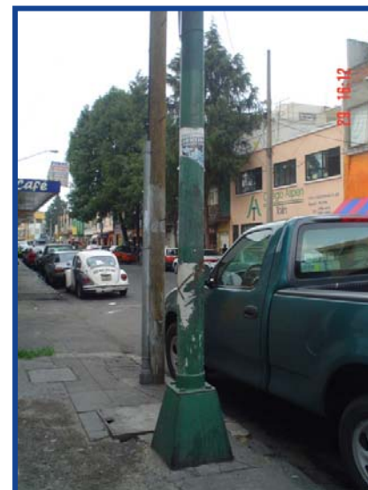
RED AGUA POTABLE
