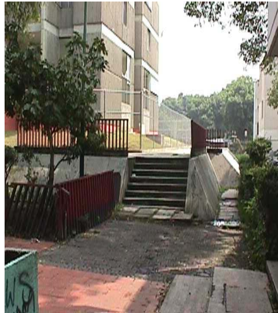
Aproximadamente a 15 m del edificio S-30 se encuentra una de las torres de 17 niveles cimentadas con pilotes de punta, que pueden estar alterando las condiciones del suelo.
