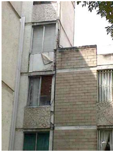
Vista de la junta constructiva entre los edificios S-32 y S-30, en donde se presenta la mayor zona de daños.
