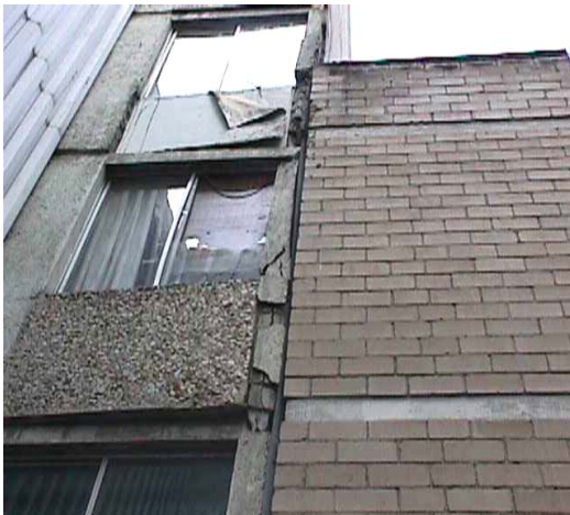
En la ventana superior, el precolado bajo de ella cayó al jardín, y el precolado del nivel inferior está fuera de su sitio, al igual que el superior, en peligro de caer.
