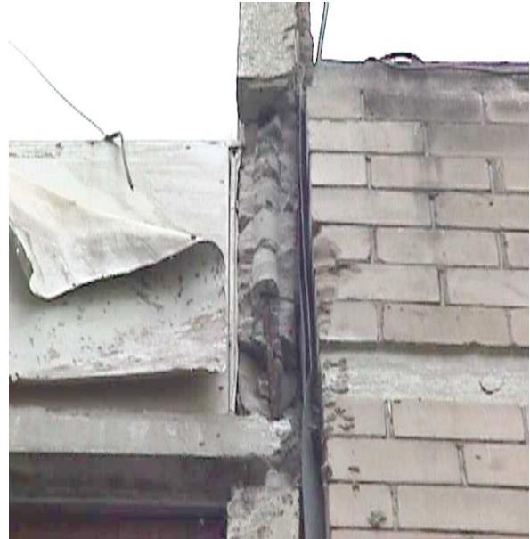
Pretil de azotea del edificio S-30 incrustado a medio entrepiso del departamento 31 del edificio S-32, aquí se aprecia que el precolado bajo la ventana ya fue sustituido por madera.
