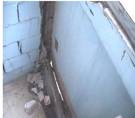
Vista del muro del edificio S-32, donde se aprecia desde el interior que el precolado no rigidiza al muro y se sale de su lugar.
