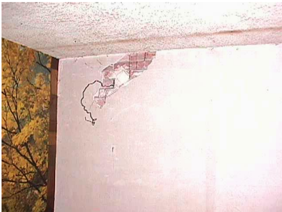
Grieta en el muro de una recámara dentro del Departamento B104
