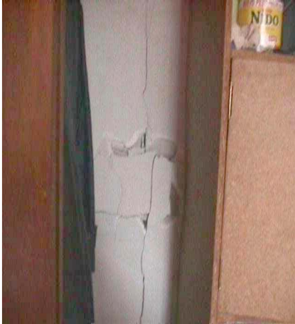
Se muestra el mismo muro del edificio S-30, donde los daños son mayores.
