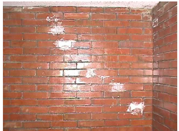
Grieta en el muro de una recamara dentro del Departamento 402
