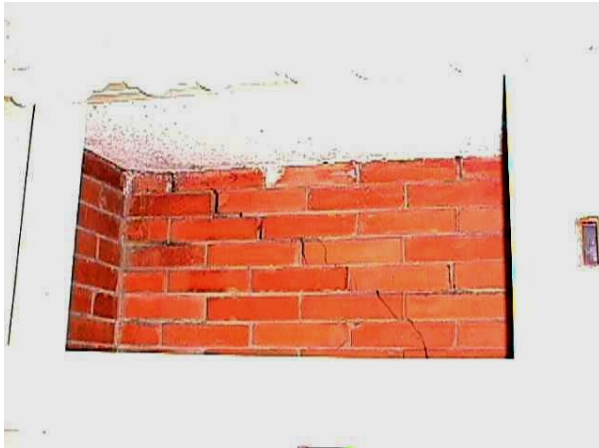
Grieta en el muro de una recamara dentro del Departamento 102
