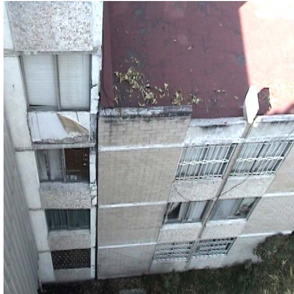
En esta imagen se aprecia el desplome sufrido por el edificio S-30, que es del orden de 14 cm. hacia el sureste, en su parte superior.
