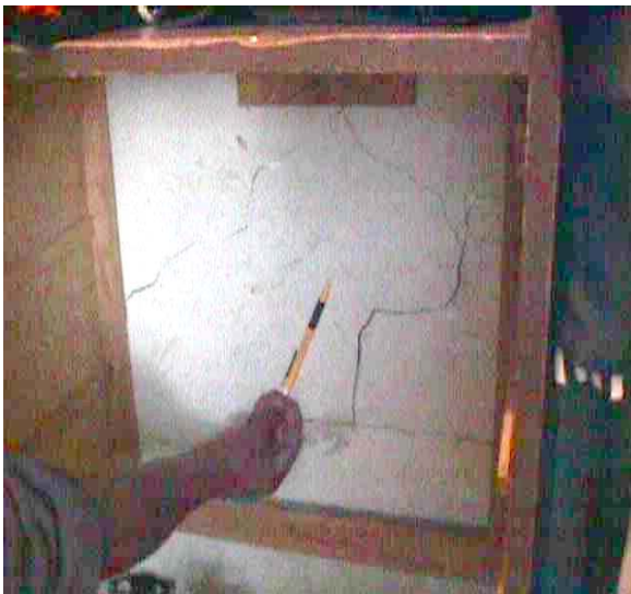
Muro en el clóset del edificio S-30, donde se aprecia la fisura escalonada, típica de hundimientos diferenciales.
