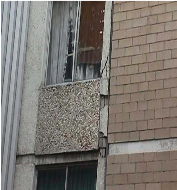
Ventana de los departamentos del edificio S-32, originalmente no estaba proyectada en esa esquina, según el proyecto arquitectónico.
