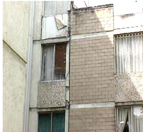
Elevación de la unión entre el edificio S-32 con el S-30. El muro deformado no tiene esquina con alguno con otro que lo rigidice y el precolado bajo la ventana no proporciona dicha rigidez.
