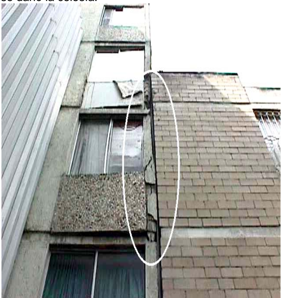
En esta imagen se hace notar la deformación del muro de borde No 11, notando que hay material atrapado entre los dos edificios.
