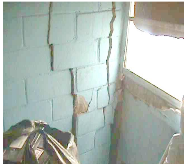
Fractura en el muro de borde del departamento 21 del edificio S-32.
