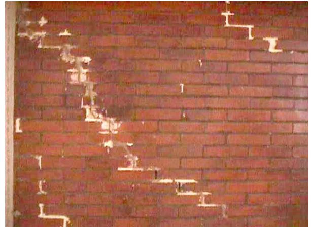
Grieta en el muro de una recamara dentro del Departamento 302
