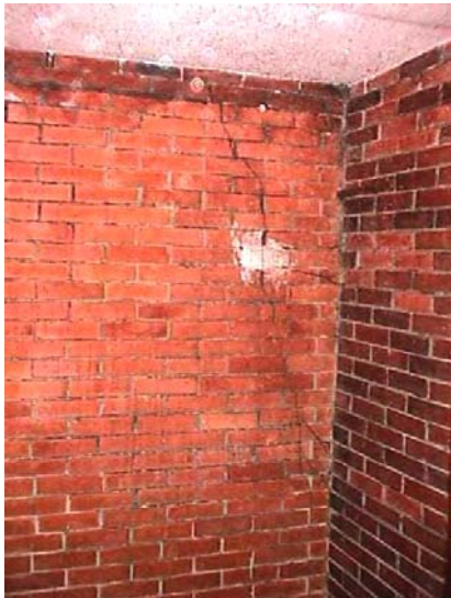
Grieta en el muro de una recamara dentro del Departamento 02
