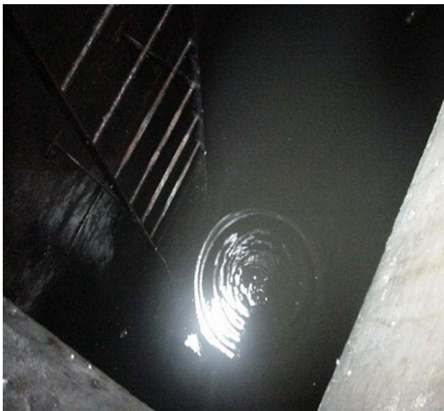
Foto 3. Celda de cimentación inundada
