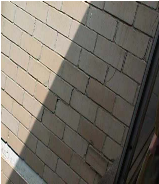
Fisura escalonada típica de hundimientos diferenciales, encontrada en la fachada principal del edificio S-34.
