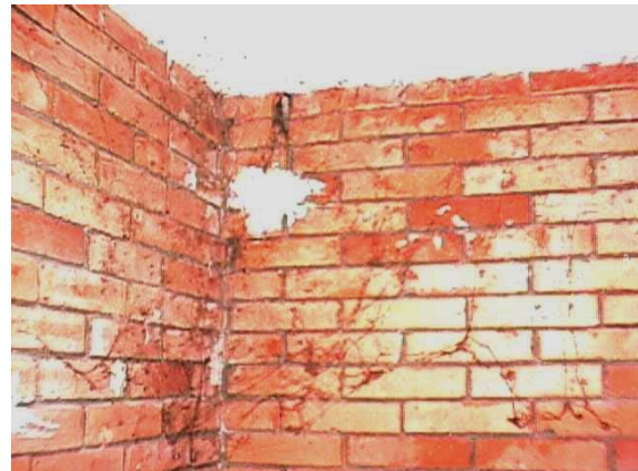
Grieta en el muro de la estancia dentro del Departamento B104
