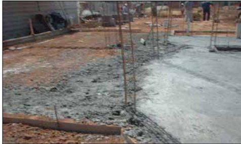
Interrupción indebida del colado de la losa de cimentación. La junta fría que se forma, causará problemas posteriores.
