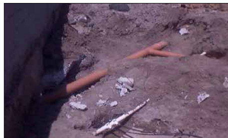
Ductos para drenaje y agua potable. Los dos se colocaron al mismo nivel, debiendo estar el sanitario debajo del hidráulico, según especificaciones de dominio público
