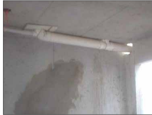
Instalación sanitaria con tubería de PVC. Se observa la demolición exagerada del muro para atravesar el tubo.
