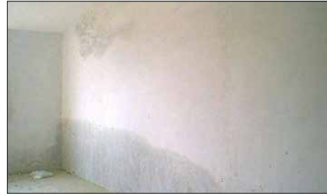
Humedad en interiores de muros por deficiencias en la impermeabilización. El problema desencadena en presencia de salitre y desprendimiento de los aplanados
