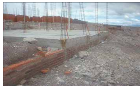
Murete de tabique rojo como base de losa de cimentación y muro de contención, el defecto es que no se le coló ningún castillo para rigidizarlo. La cimentación ya no funciona como losa y es una anomalía a reportar por el supervisor.
