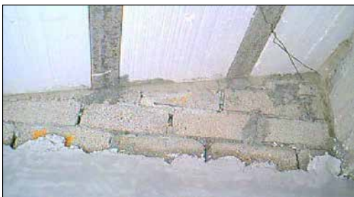
Procedimientos constructivos defectuosos, las viguetas no se apoyan sobre una trabe, sino directamente sobre el muro. Son detalles que el supervisor debe cuidar.
