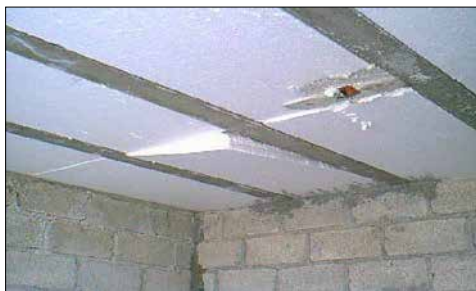
Losa de vigueta y bovedilla de poliuretano . El desprendimiento de estas piezas durante el colado crea problemas al aplicar los acabados en el plafón. Las viguetas se apoyan directamente sobre el block, lo que es incorrecto
