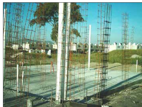
Ductería para instalaciones hidrosanitaria y de energía eléctrica ahogas en losa de cimentación. Hay que vigilar que no les entre mezcla o residuos sólidos
