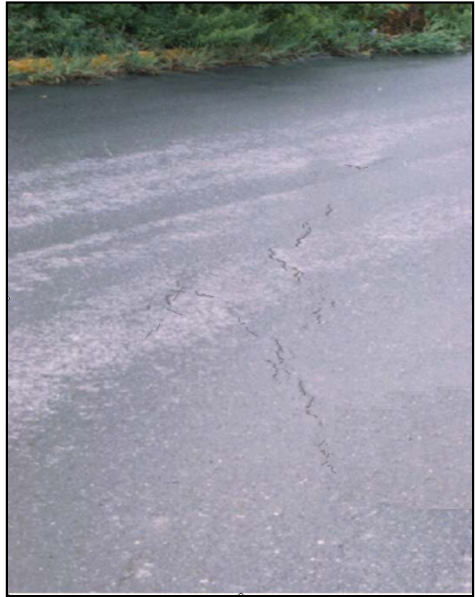
Fotografía IV.2.2.2. Agrietamientos en las vialidades.
