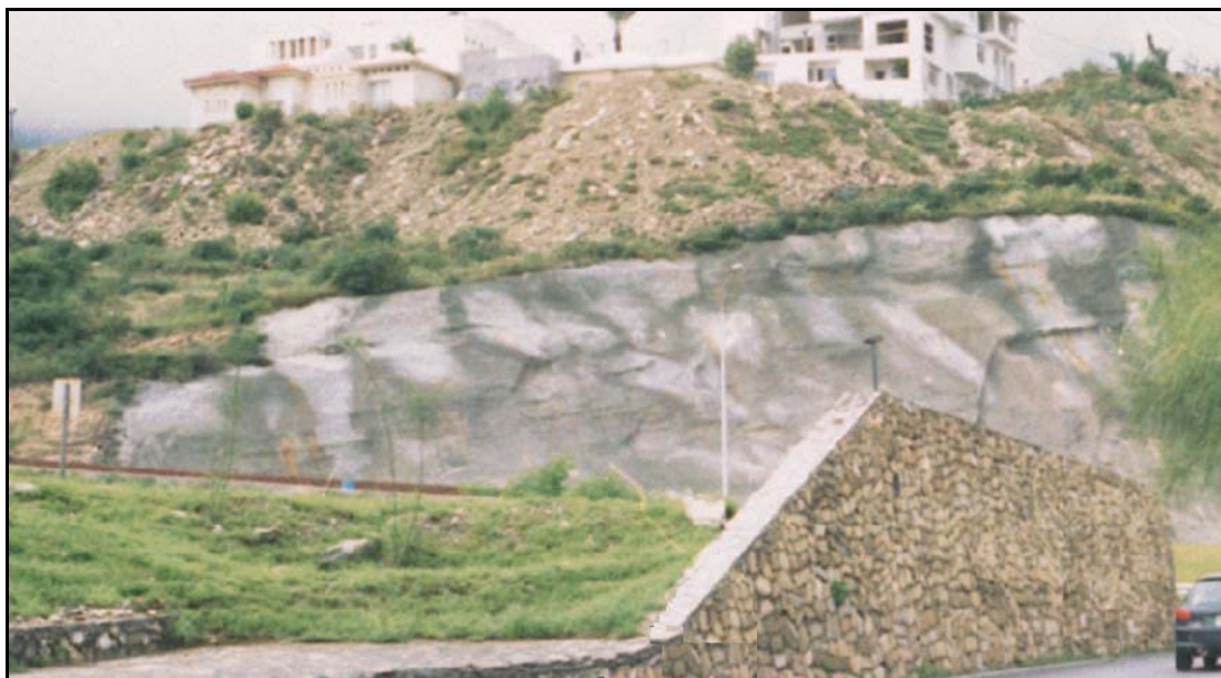
Fotografía IV.2.3.1. Construcción sobre laderas inestables con métodos de estabilización insuficientes.
