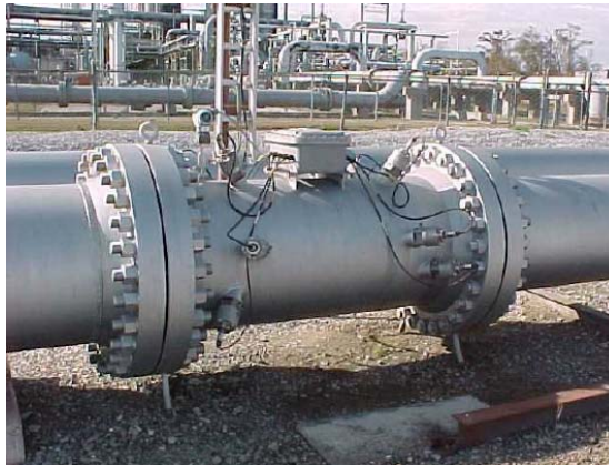
FIG. 3A. Carrete de Medición. Medidor Ultrasónico contado en línea.
