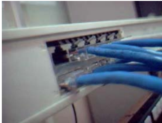
Figura 3.19 Hub del Laboratorio de Redes y Seguridad
