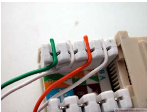
Figura 3.5 Cable UTP en Jack
