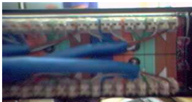
Figura. 3.14 Cable UTP en el panel
