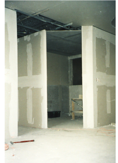
Fig. 65 Delimitación de cocina y tendido de bastidor en plafón Departamentos en la Col. Roma, Azamar M. Aurora Constructora Yama (2003)
