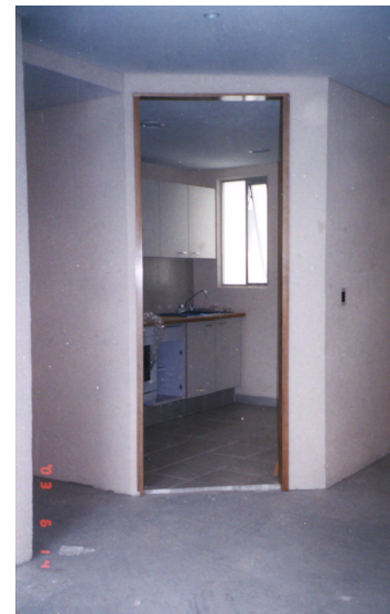
Fig. 66 Muros y plafón de tablaroca terminados Departamentos en la Col. Roma, Azamar M. Aurora Constructora Yama (2003)
