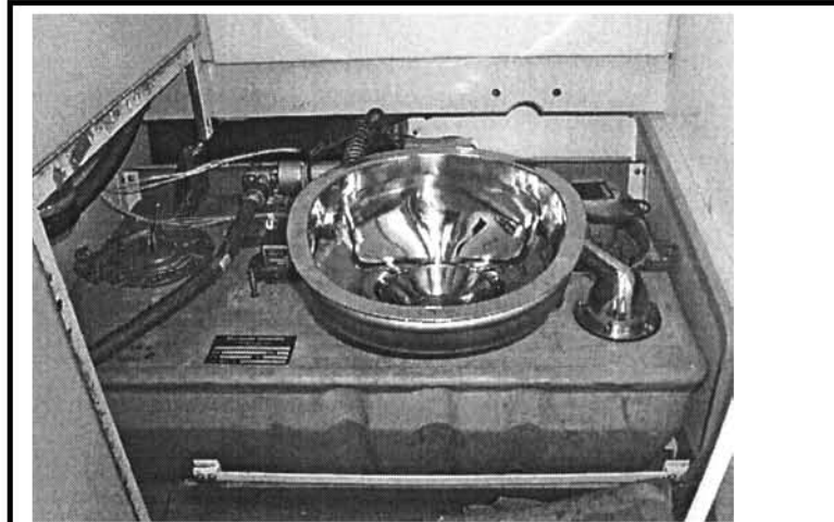
Fotografía 4. Tanque de desperdicios del sanitario.
