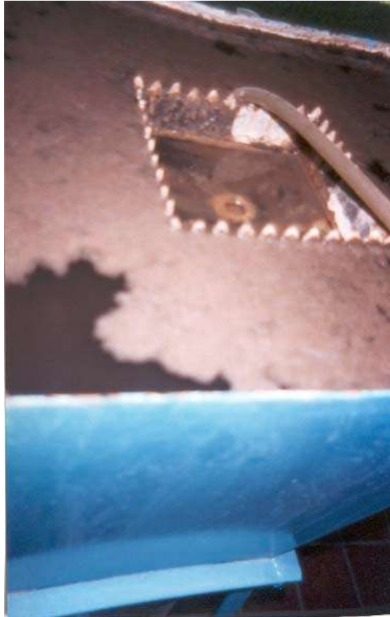
Figura 30. Nata de la superficie del clarificador secundario de la planta piloto.
