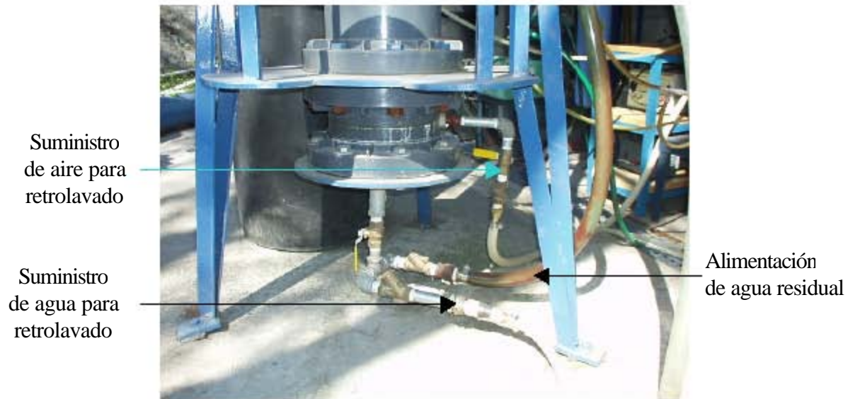
Figura 2.3 Conexiones en la parte inferior del filtro, alimentación de agua residual, suministro de agua y de aire para retrolavado
