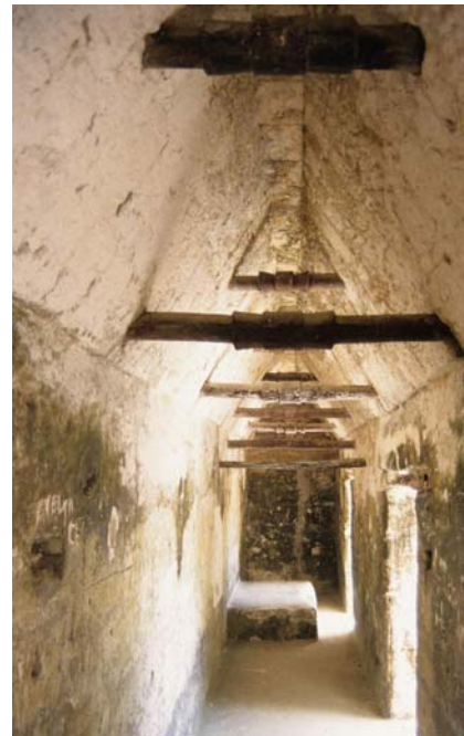
Fig. 201 Vigas de madera in situ en el segundo piso de la Estructura 5D-52
