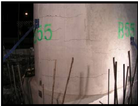
Fig. 4.1.48. Patrón de agrietamientos final de la columna B55 sin collarín (IINGEN 2005)
