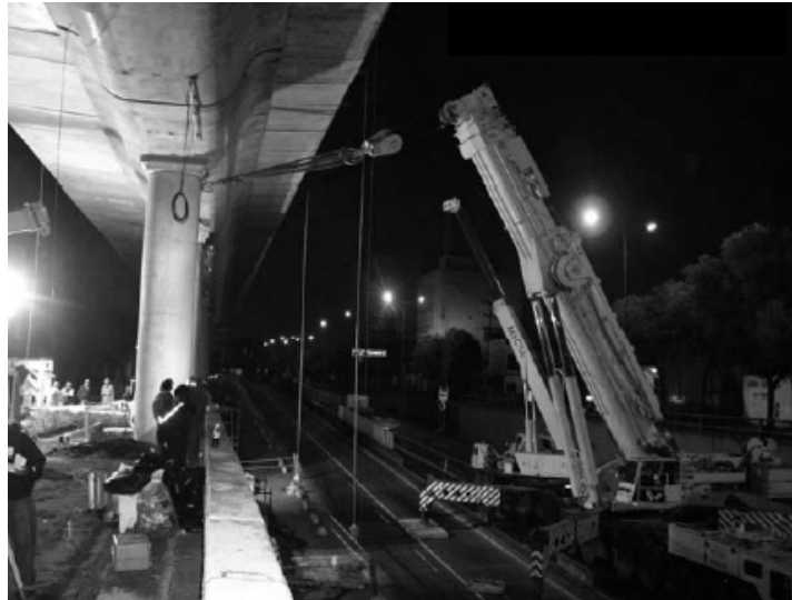
Fig. 2.3.2. Prueba de tracción a una columna del segundo piso del periférico
