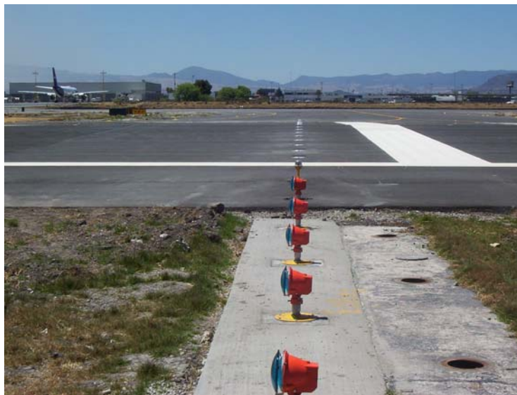
Fotografía V.39.- Unidades luminosas de barra de ala en el umbral de la pista
