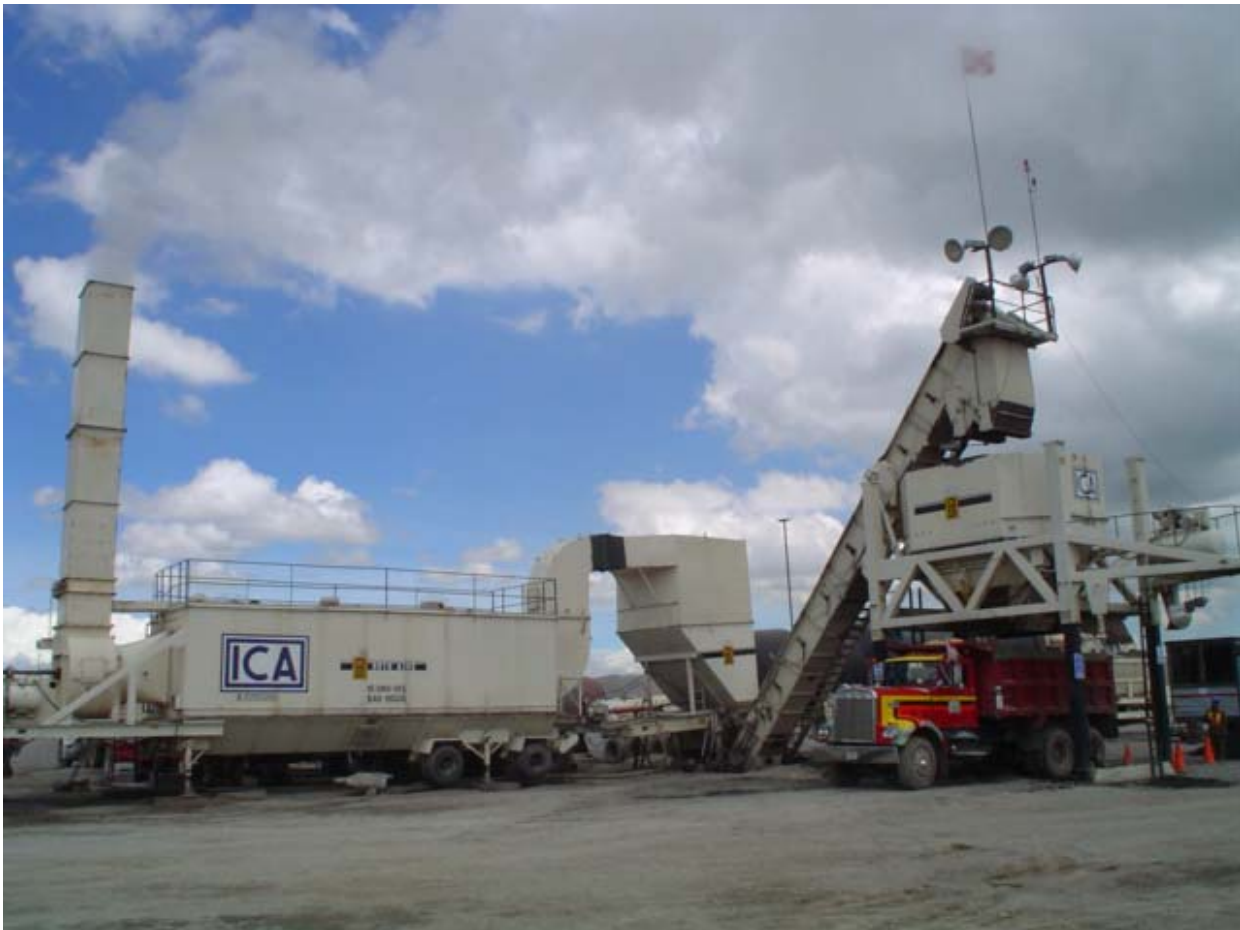
Fotografía I.6.- Planta de asfalto empleada para la fabricación de mezclas asfálticas
