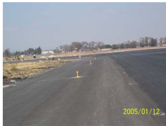
Fotografía V.47.- Unidades de borde de pista instaladas.
