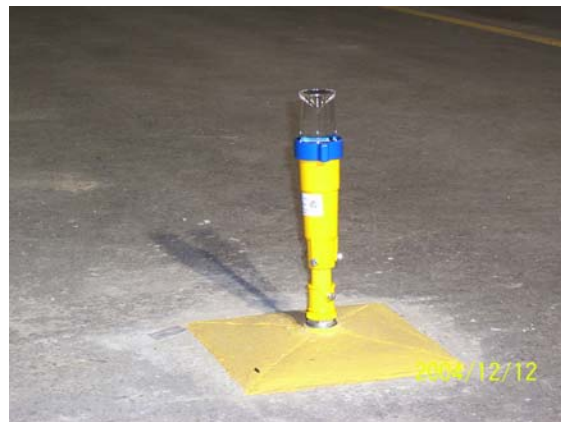
Fotografía V.49.- Unidad luminosa instalada.
