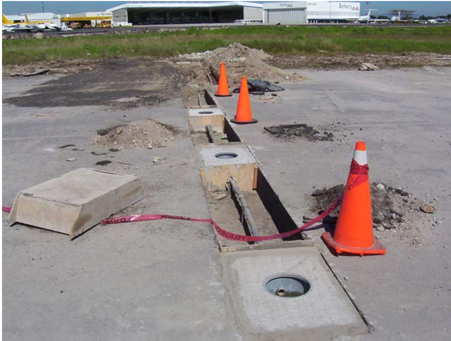
Fotografía V.44.- Instalación de cimientos registro para luces de barra de parada en rodajes.
