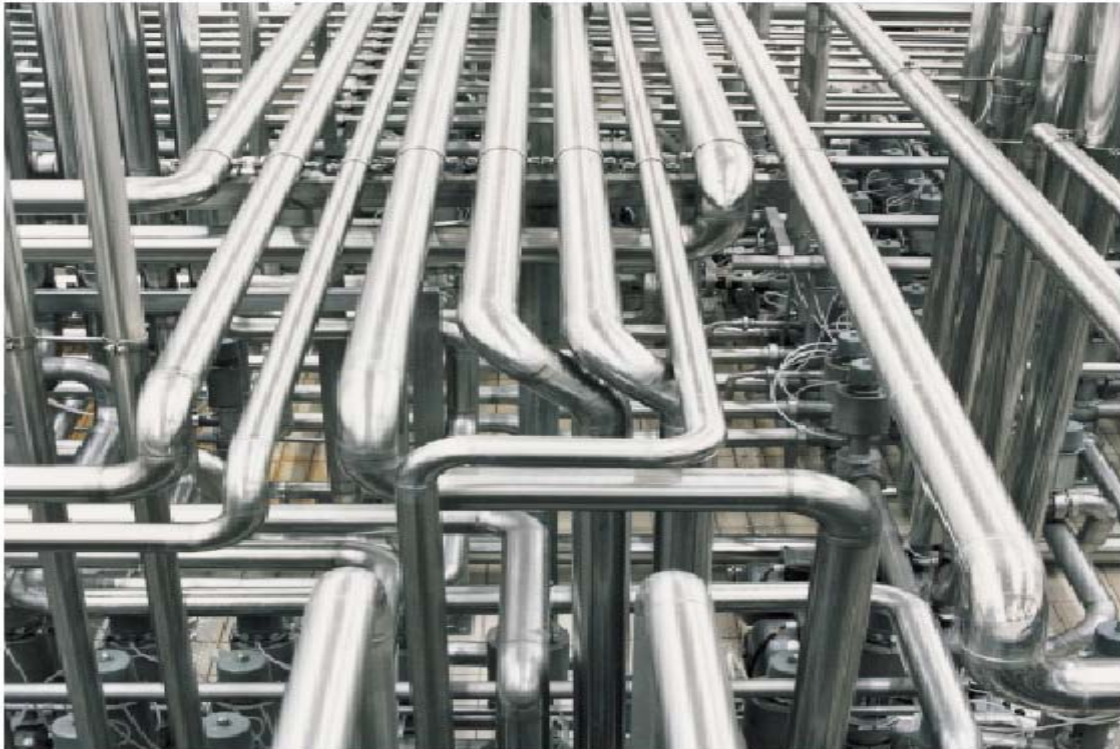
Figura 5.3 Vista de líneas de tuberías industriales para la conducción de materias primas ó graneles. (GEA Liquid Processing Division 1998) 9
