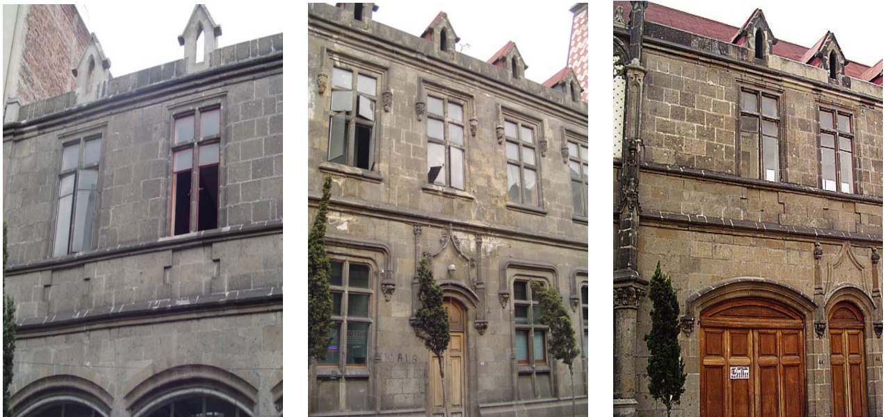
Lámina 93 y 95. A la izquierda y derecha, sección de bomberos y de los juzgados respectivamente, se puede observar la adaptación de la moldura del friso como vierteaguas para las ventanas. Lámina 94. A diferencia de las secciones anteriores, para las ventanas de la comisaría, imagen del centro, se crearon vierteaguas individuales. Asimismo, se puede apreciar la altura de las ventanas dispuestas a nivel de la vía pública y el corte de cruz latina en las secciones de bomberos y juzgados y de doble cruz en la de la comisaría.
