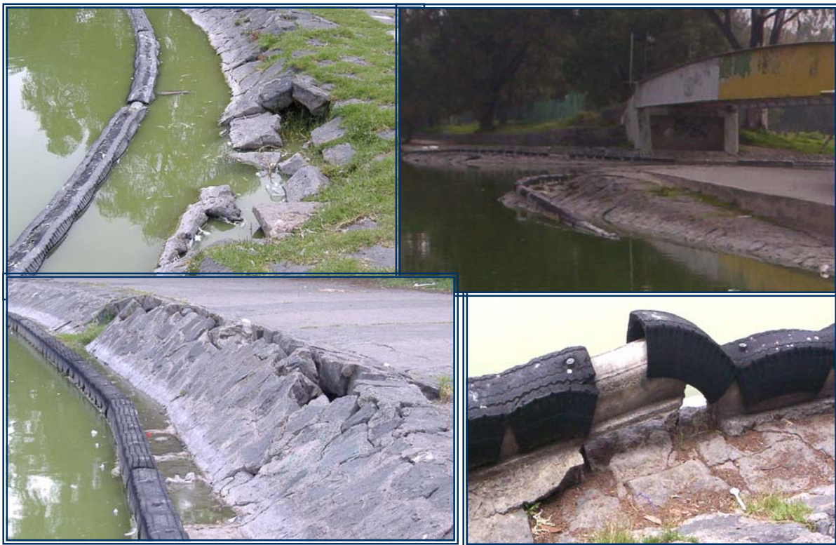
Figura 2.18. Fallas y asentamientos en el dique perimetral del lago del BSJA.
