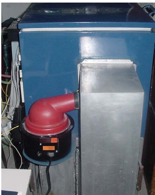
Figura 4.7 Se muestra la ubicación del humidificador, que proporciona la humedad a través de un ducto de la cámara de corrosión.
