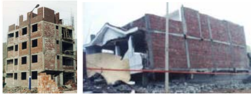
Figura 1.3 Construcciones de viviendas con mampostería, falla de muros de mampostería en un evento sísmico
