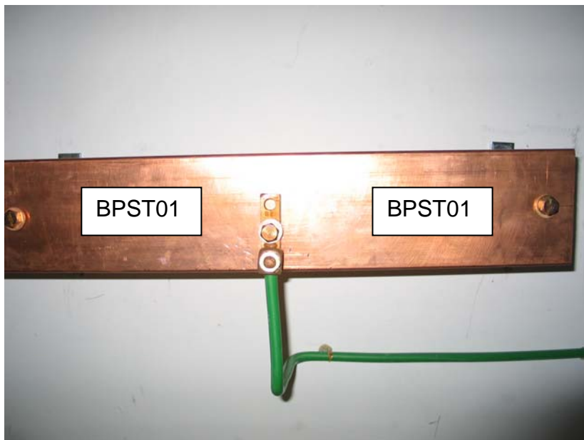
a) Etiquetado en el Sistema Principal de Tierras ubicado en el MDF.
