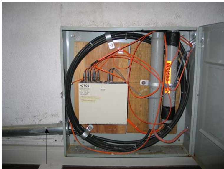
Figura 5.4c. Canalización proveniente de RedUNAM.
