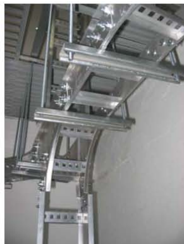
Figura 5.4q. Vista de la vertical que paso por el IDF-Octavo Piso.
