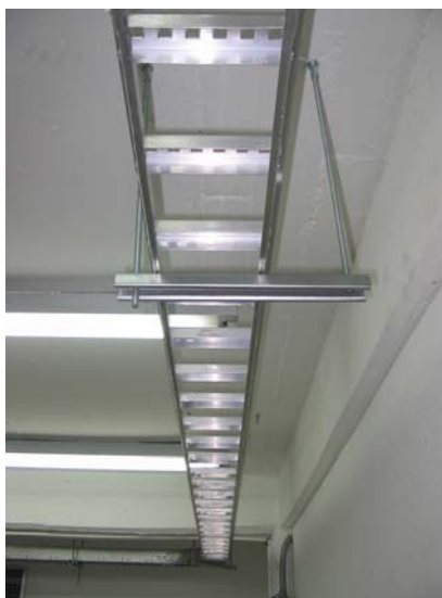
Figura 5.4d. Canalización proveniente de la acometida de RedUNAM, hacia el MDF.
