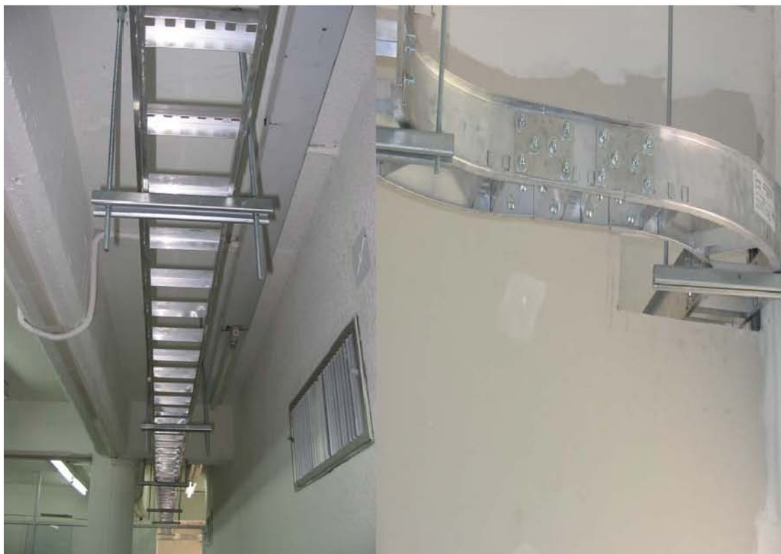
a) Canalización Horizontal piso 9.
