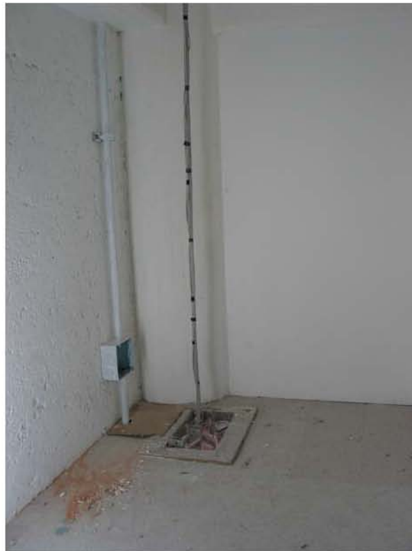
Figura 5.4r. Vista del IDF-Primer Piso.
