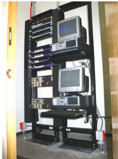
Figura 5.4n. Vista del IDF-Entrepiso de la RedDGB.
