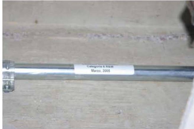
Figura 5.4v. Ducto utilizado en la canalización horizontal del piso 9 principalmente en lugares de difícil acceso.
