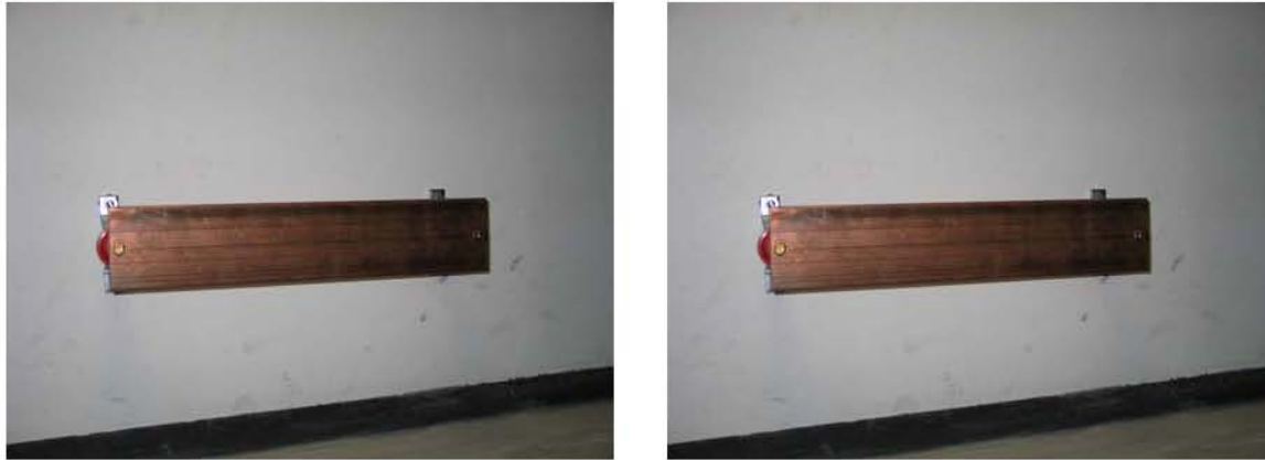
Figura 5.4.2c. Barras de Tierra Física en IDFs llamadas TGB.
