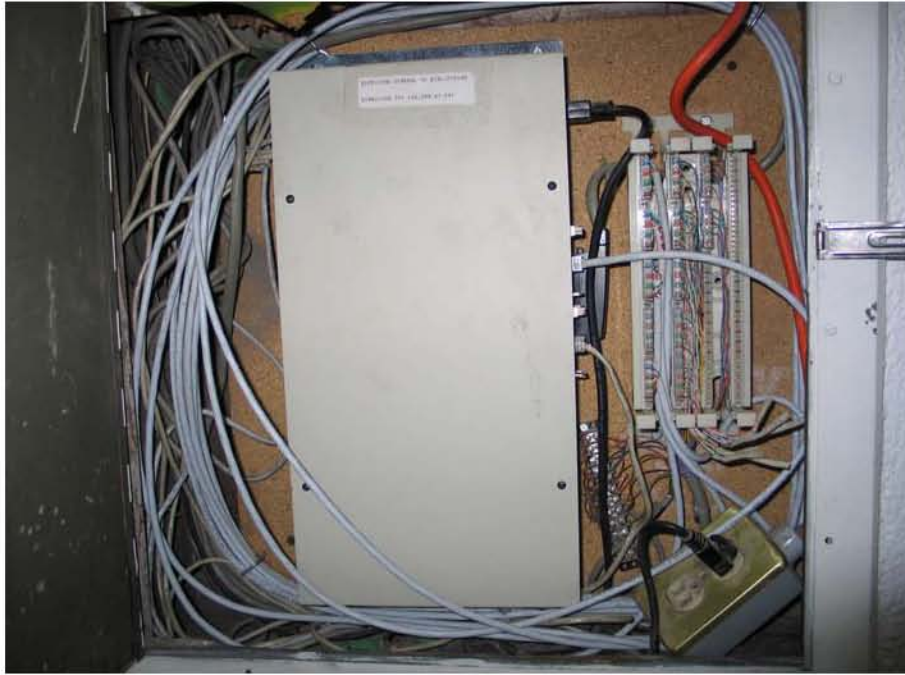
Figura 4c. Cableado de registros con concentradores Cabletron a regleta y conexiones de peine.
