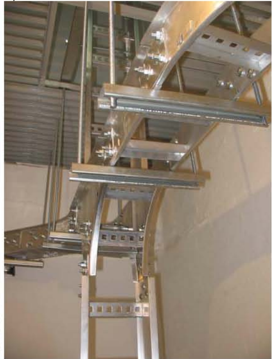
d) Canalización en el IDF
