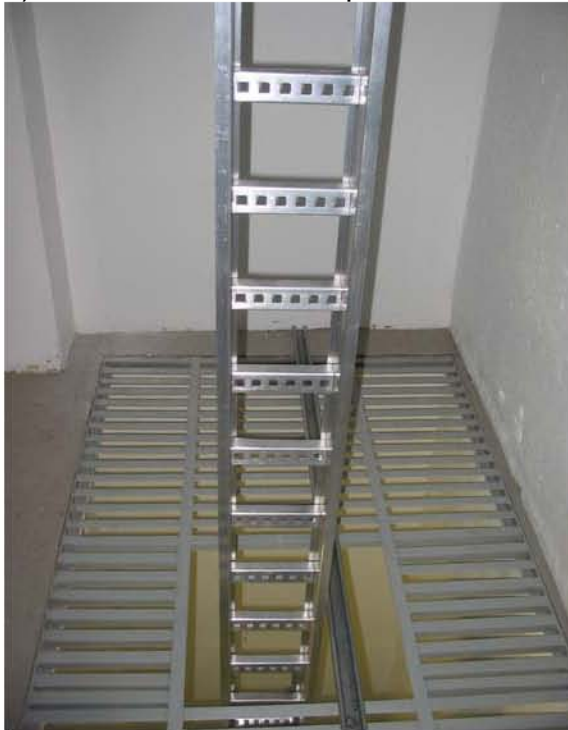
c) Canalización hacia el IDF
