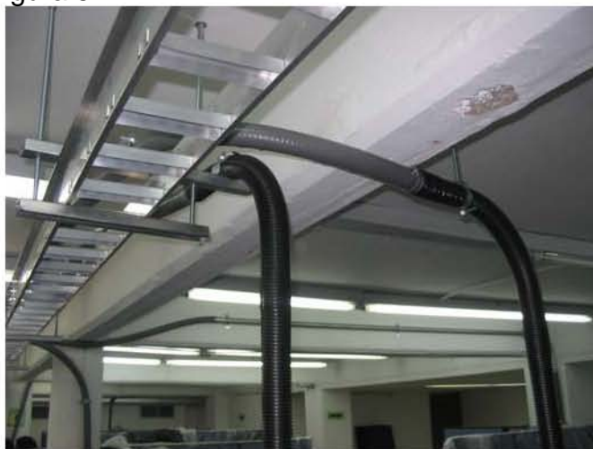
Figura 5.4w. Al centro de la figura se alcanza a apreciar el ducto y el flexiducto de canalización.
