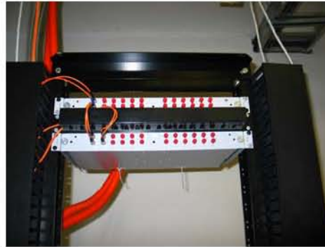
Figura 5.4.3g. Modulo de Fibra en el rack principal de datos en el MDF.
