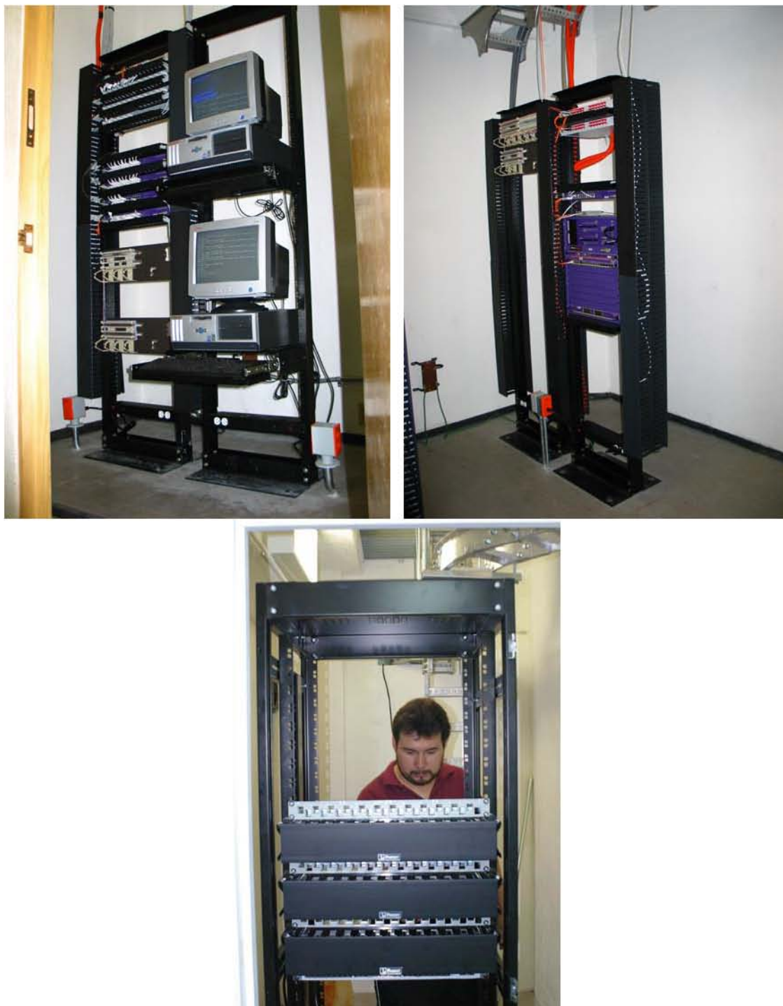
Figura 5.4.3ñ. La primer foto muestra un sistema de racks instalados en el IDF-Entrepiso, la segunda foto muestra dos racks instalados en el MDF y la tercer foto muestra un gabinete instalado en IDF-Octavo piso, para limitar la cantidad de polvo que pudiera entrar el sistema de cableado.
