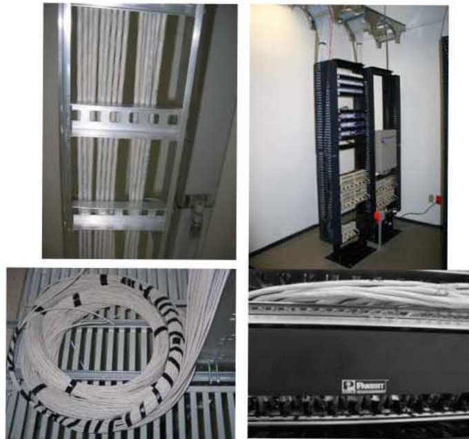
Figura 5.4.3v. Distribución de UTP Marca R&M en las Horizontales de la RedDGB.
