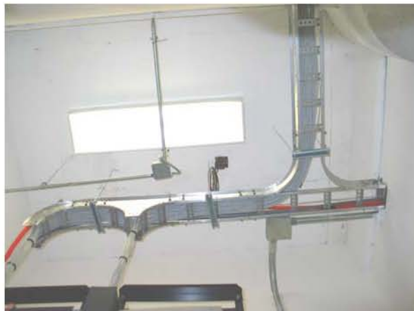
Figura 5.4ñ. Vista de la canalización en el IDF-Consulta
