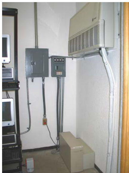
Figura 5.4o. Vista del HVAC y el UPS del IDF-Consulta.
