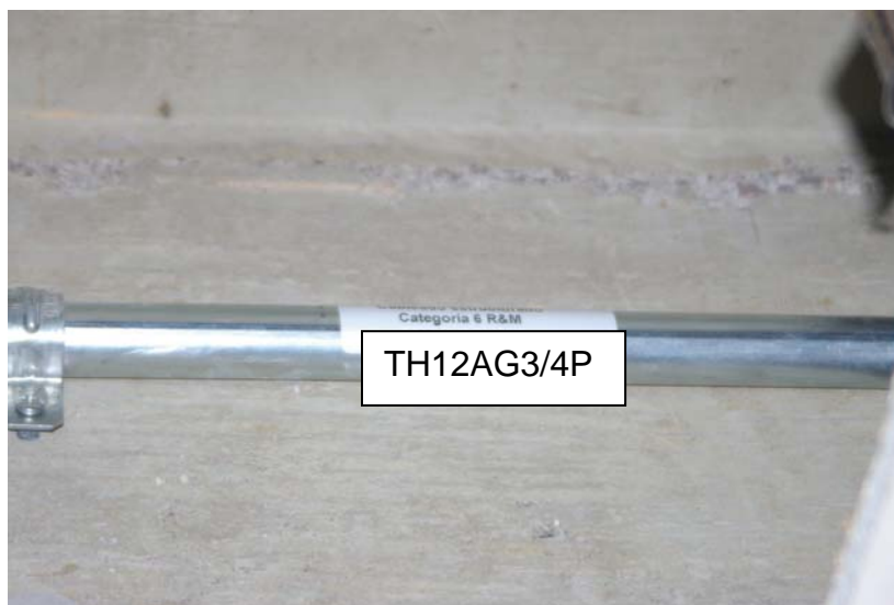
b) Etiquetado en la Canalización Horizontal del Piso 9.
