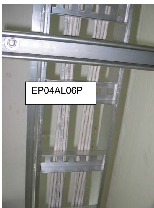
c) Etiquetado de Escalerilla Horizontal en Piso 10.
