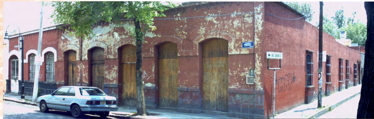
Inmueble abandonado ubicado en la calle de Presidente Carranza esquina con 5 de Febrero.
