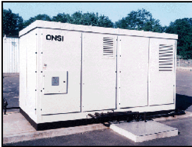
Figura 2.2 Estación Generadora de Celda de Combustible PAFC.
