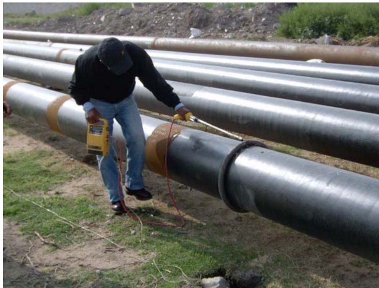
EQUIPO PARA DETECTAR CONTINUIDAD ELECTRICA (HOLYDAY)
