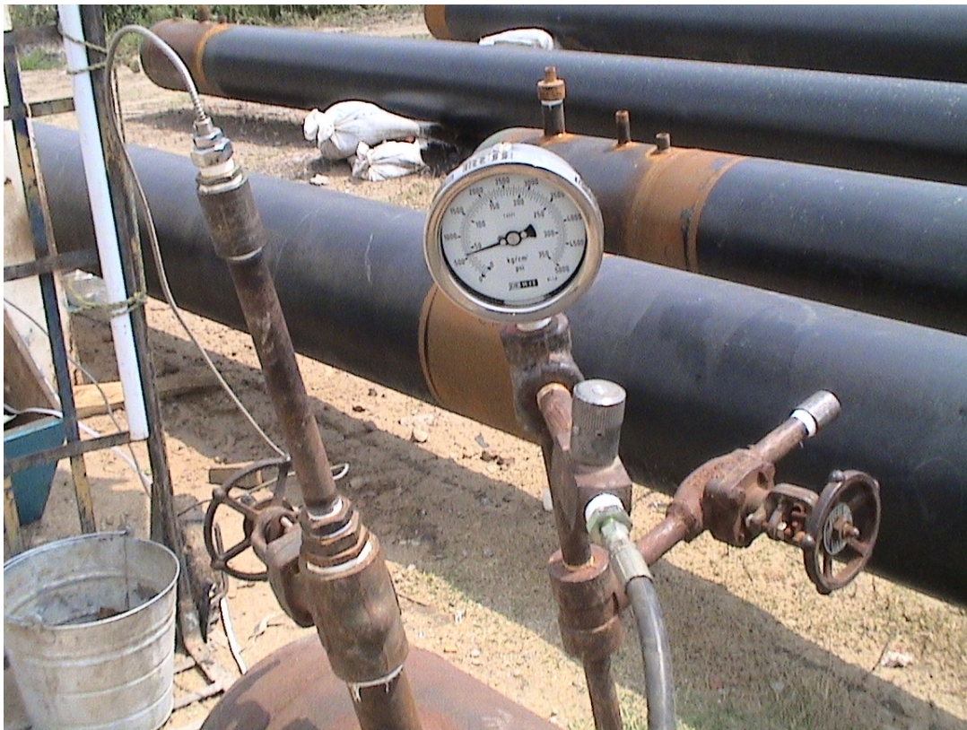
MANÓMETRO PARA CONTROLAR LA PRESIÓN DEL TUBO EN LA PRUEBA
