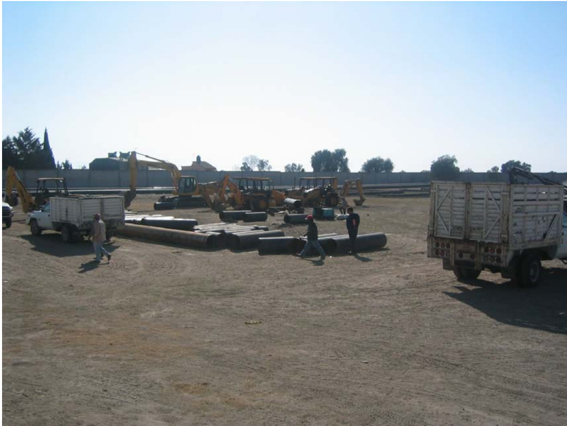
PATIO DE TUBERIA
