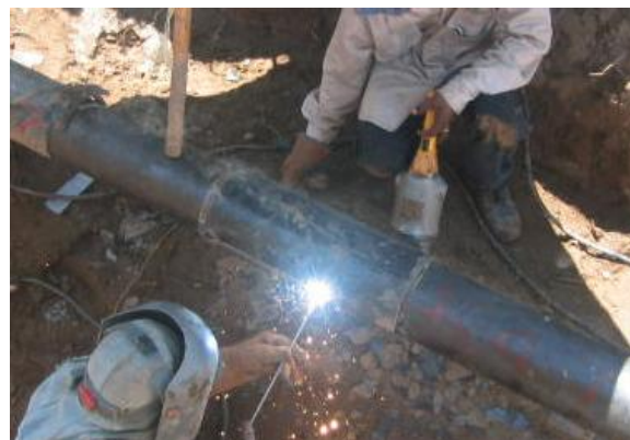
SOLDADURA LONGITUDINAL DE ALTO RIESGO EN ENVOLVENTE METAL A METAL
