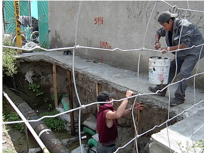
RETIRO DE LODOS
