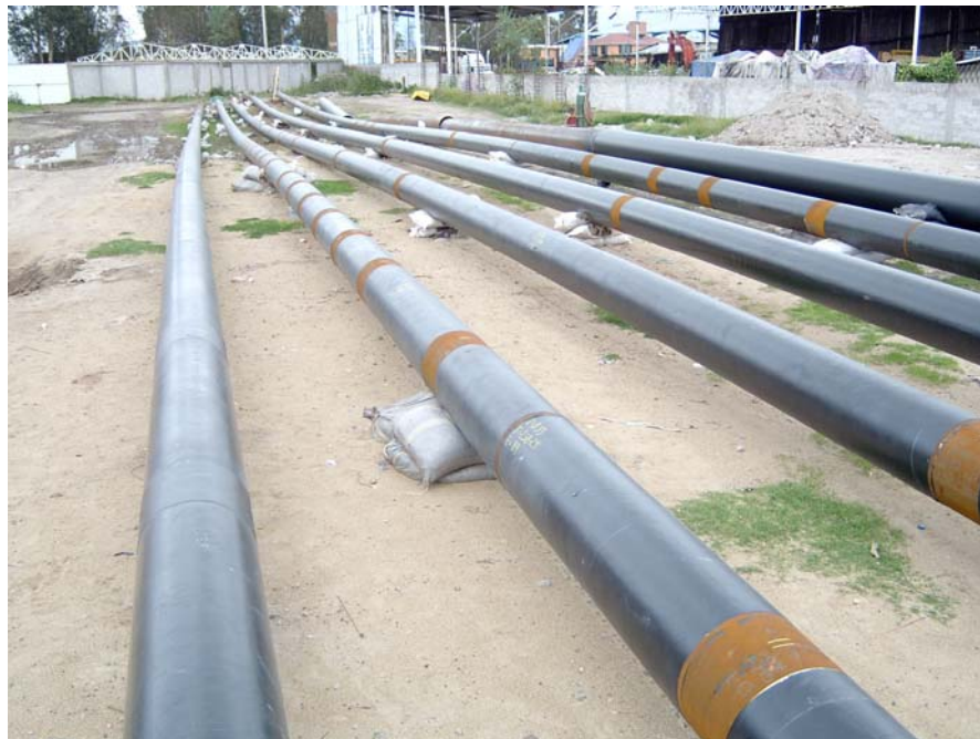
JUNTAS SOLDADAS SIN PROTECCIÓN MECÁNICA DURANTE LA PRUEBA HIDROSTÁTICA
