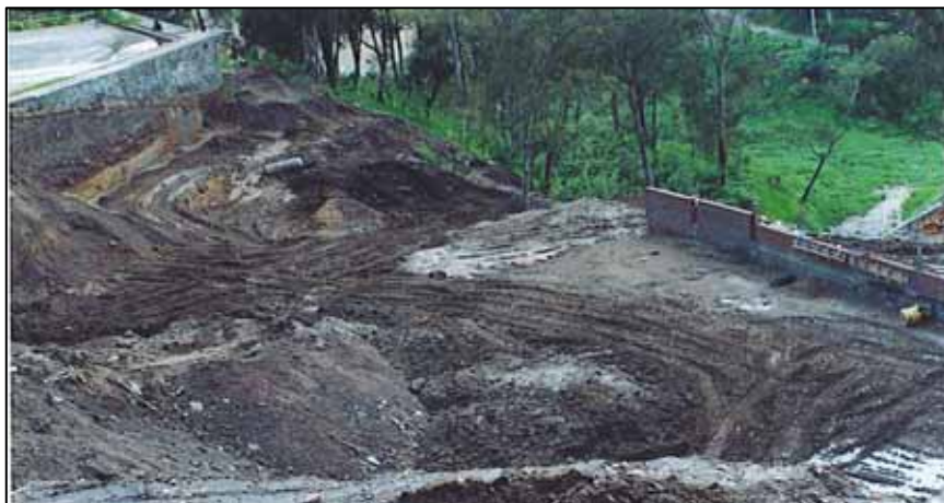
Foto 1. Relleno de barranca en el Distrito Federal.
