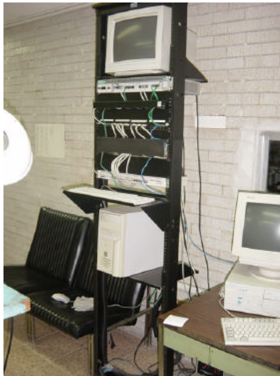
Fig. 2.2 - Centro de distribución de cableado con equipó y conexiones instaladas
