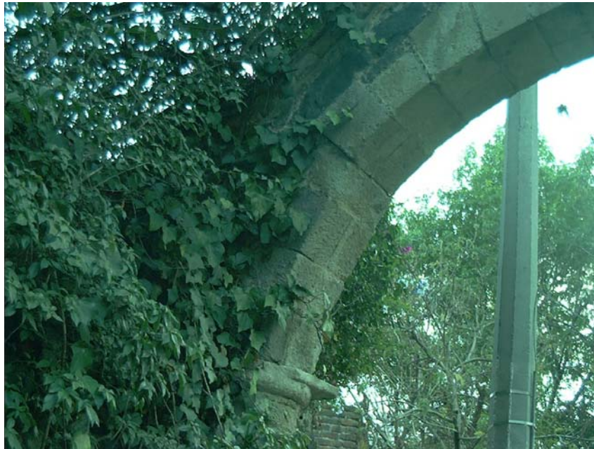
DESPLAZAMIENTO DEL APOYO I DE LOS ARCOS (FOTOGRAFÍA TOMADA DESDE EL LADO ORIENTE) FOTOGRAFÍA 2.1
