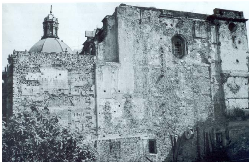
BÓVEDA REFORZADA CON CONCRETO Convento de San Francisco, Centro Histórico de la Ciudad de México FOTOGRAFÍA 1.1
