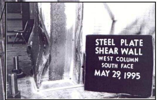
Fig. I.2-7. Pandeo local de una columna, al final de la prueba. (Driver et al; 1996)
