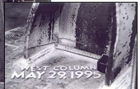
Fig. I.2-6. Fractura de la columna oeste, en su base (Driver et al; 1996)
