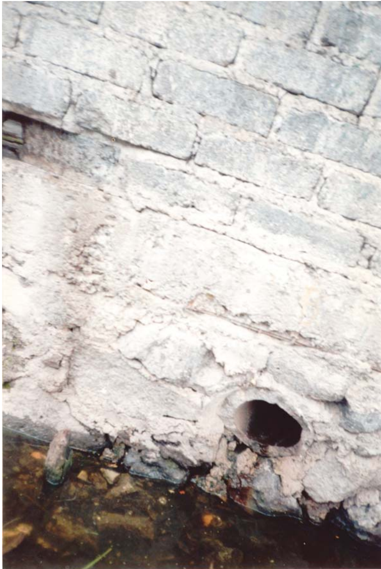
Ilustración 8. Vertido clandestino de aguas domésticas.
