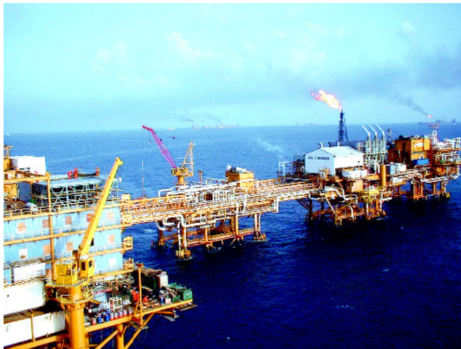
Conjunto Nonoch-Ha: Plataforma Habitacional, instalaciones de bombeo y plataforma de separación de gases.
