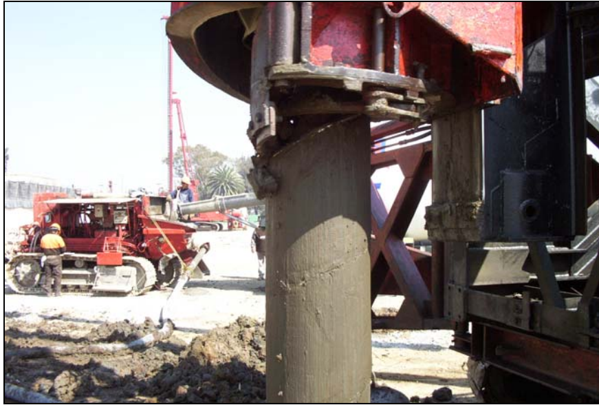
Figura V.8 Continuación del proceso constructivo, se aprecia la extracción del material al momento que se va aviendo el concreto dentro de la excavación
