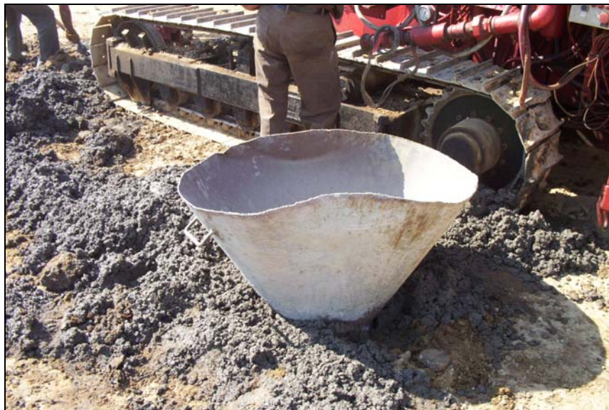
Figura V.11 Cono colocado en posición para el vaciado de la grava sobre la cabeza de las inclusiones
