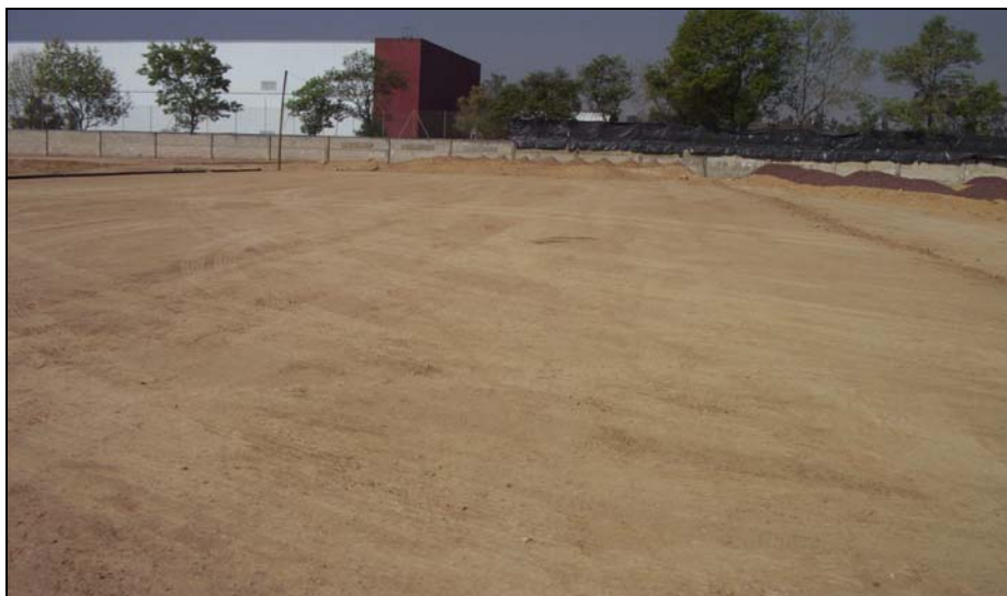
Figura V.13 Vista general del aplanado a nivel de piso terminado sobre el cual se desplantara la losa de cimentación
