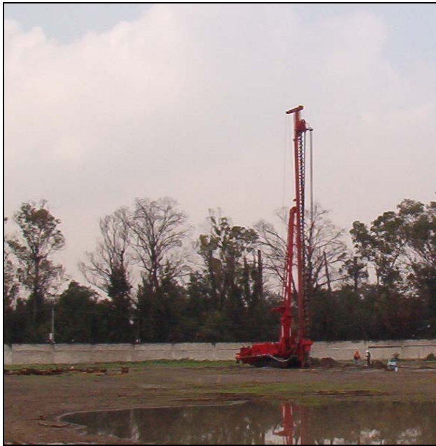
Figura V.2 Vista general equipo Starsol
