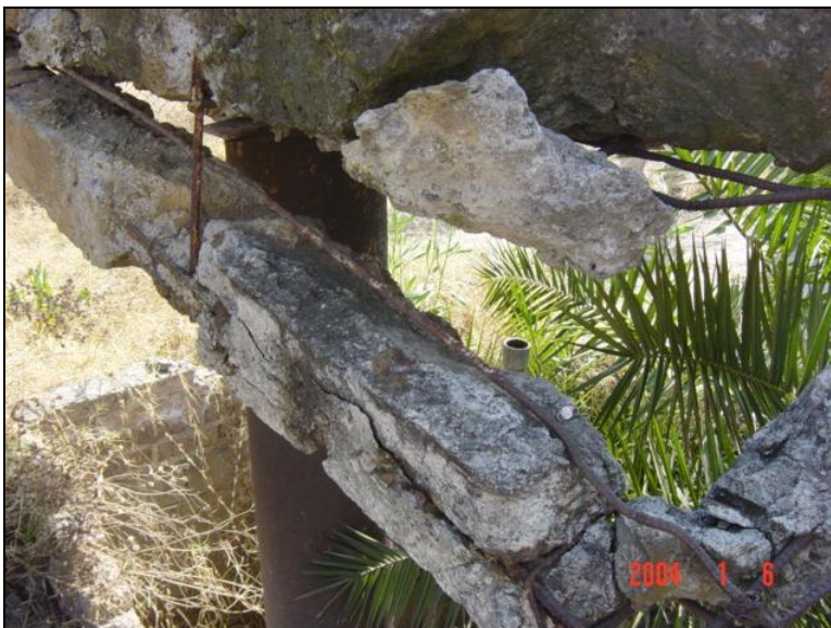
Figura II.9 Imagen que muestra el hundimiento que ha sufrido la zona
