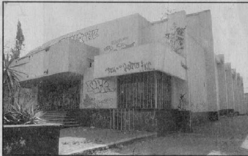
La marquesina desapareció y la fachada está llena de graffiti y "tagging".
