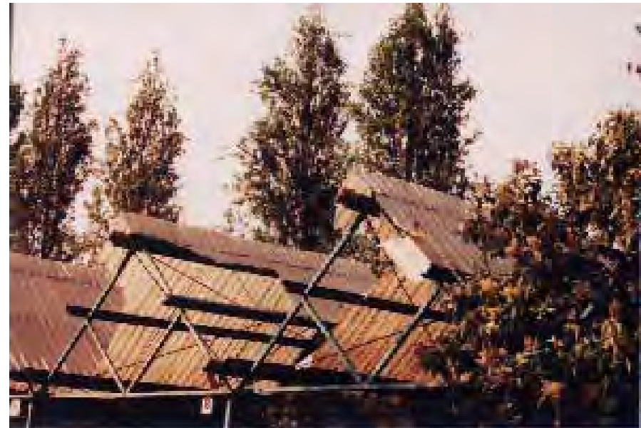
Ilustración 24. El material elegido para las cubiertas no ha sido el mejor, ni en el aspecto económico ni en el funcional, ya que los usuarios no les han podido dar mantenimiento y han sobrepuesto otros materiales para satisfacer sus necesidades.
