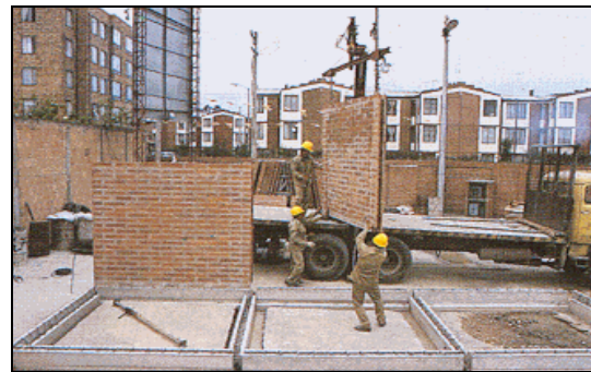
Fig. # 57. Paneles De Tabique: "LOSAS LTDA" Imagen tomada con fines académicos de: Sistemas Estructurales Aplicados A La V.I.S.
