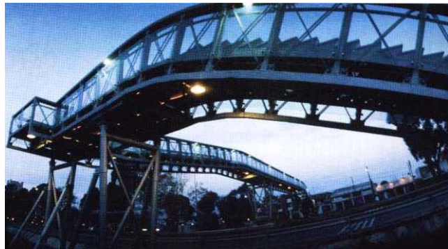
Fig. # 2. Estructura tubular en acero. Puente peatonal para el sistema de transporte masivo de Bogotá. Imagen tomada con fines académicos de: Ara. Ricardo López.
