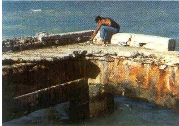
Fig.7.6. Corrosión extrema en estructura marina. Fuente: AMEGAC.
