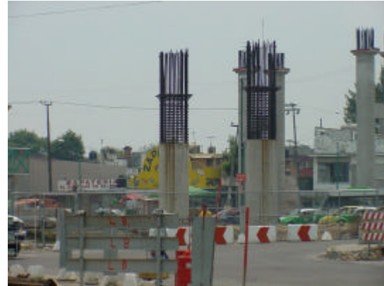
Fig.3.14. Acero oxidado en una columna de concreto del Distribuidor vial Zaragoza. (Etapa de construcción). Ciudad de México. 2002.
