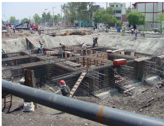
Fig. 1.5. Refuerzo de cimentación. Distribuidor Vial de Zaragoza. Etapa de Construcción. Ciudad. de México, 2002.
