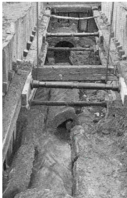
Fig.7.2. Alcantarilla de concreto colapsada como resultado de la corrosión. Fuente: Concrete Corrosion, Concrete Protection, Biczók. p.380.
