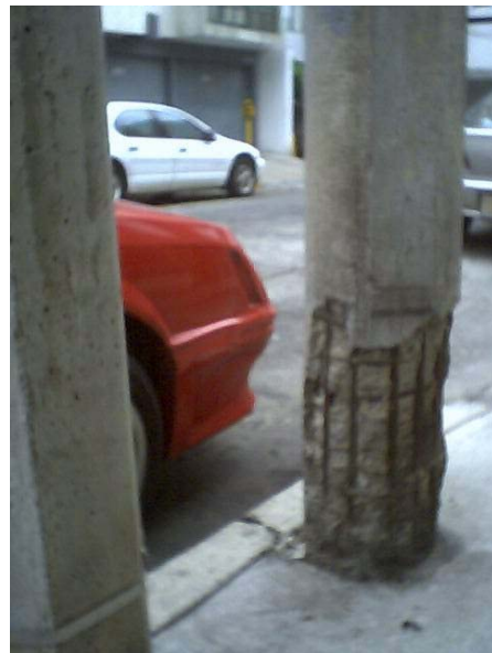
Fig. 1.4 Corrosión en un poste de luz. Col. Nápoles, Ciudad de México, 2003
