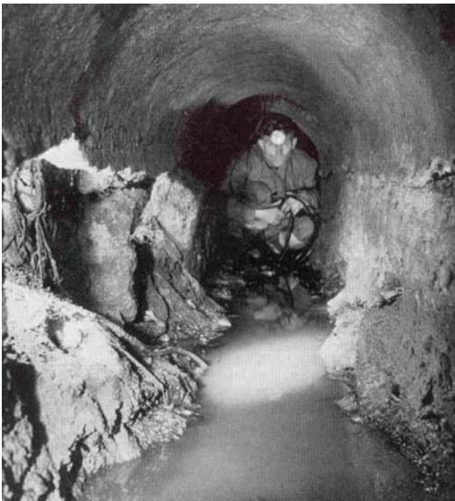
Fig.7.1. Colector deteriorado por la acción de los iones de sulfatos. Fuente: Concrete Corrosión, Concrete Protection, Riczák n.381
