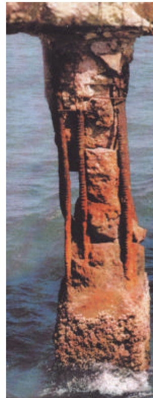
Fig.3.1. Daños por corrosión en elemento de concreto reforzado. Fuente: Manual de Inspección, Evaluación y Diagnóstico de Corrosión en Estructuras de Hormigón Armado.
