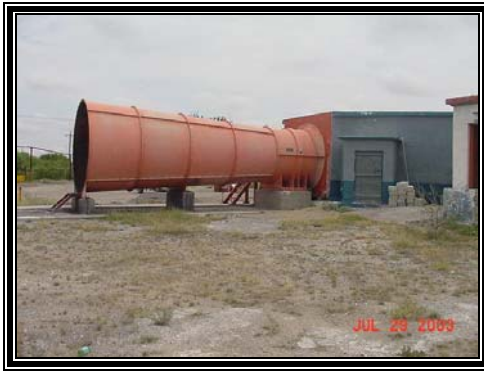
Fotografía 6.10. Extractor Principal (en superficie).
