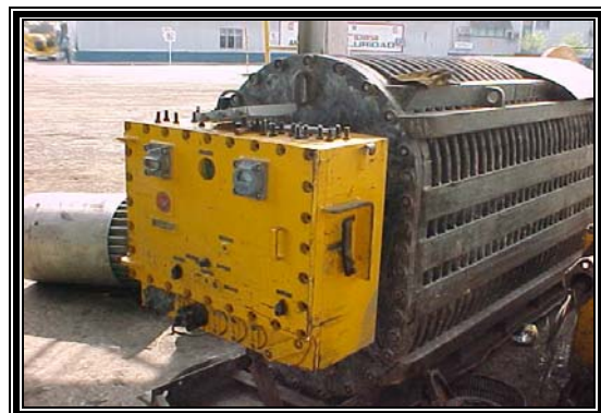
Fotografía 6.35. Transformador 315 KVA de 440 kilo voltios.
