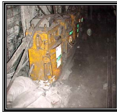
Fotografía 6.26. Bultos de dolomita junto al tren de distribución eléctrica.
