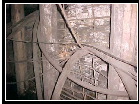
Fotografía 6.22. Se muestra lo complicado de la instalación eléctrica en el interior de la mina.
