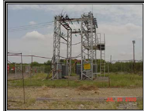
Fotografía 6.16. Subestación eléctrica que alimenta al extractor principal.
