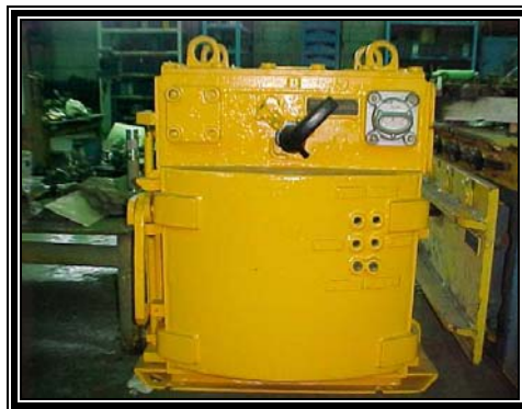
Fotografía 6.32. Palanca de corte eléctrico.
