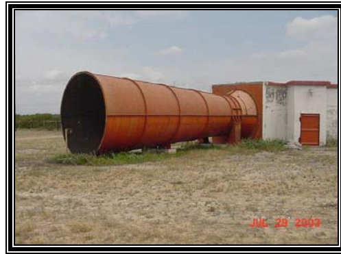
Fotografía 6.11. Extractor secundario (en superficie).
