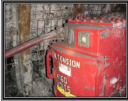
Fotografía 6.21. Presentando un cable de alta tensión que está unido al tren de control eléctrico, y se observa que están los cables sin protección de plástico, lo cual presentará una chispa en el interior.
