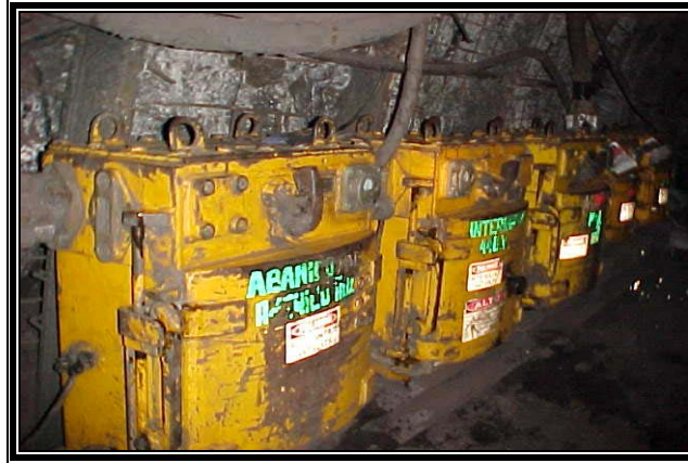
Fotografía 6.9. Sistema eléctrico (Tren de controles eléctricos). (Fuente: Mina III – MIMOSA).
