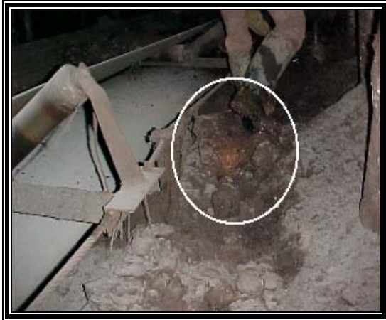
Fotografía 3.6. Riesgo de incendio provocado por la dispersión de material combustible en el ambiente laboral.
