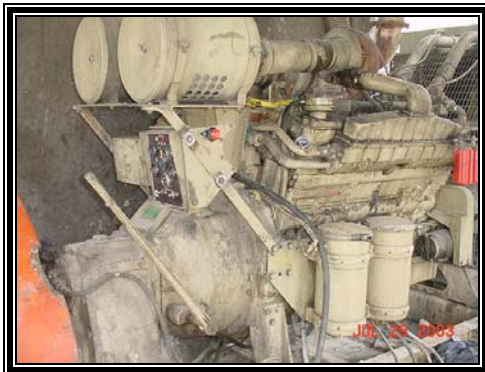
Fotografía 6.15. Motor diesel que alimenta al extractor secundario.
