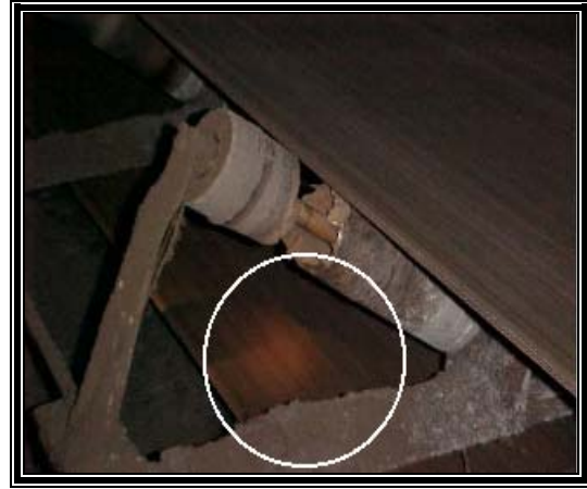
Fotografía 3.7. Riesgo de incendio por calentamiento, derivado del rozamiento entre los rodillos y la banda.
