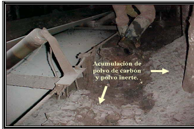
Fotografía 6.17. Acumulación de polvo de carbón y polvo inerte en los alrededores de las bandas transportadoras.
