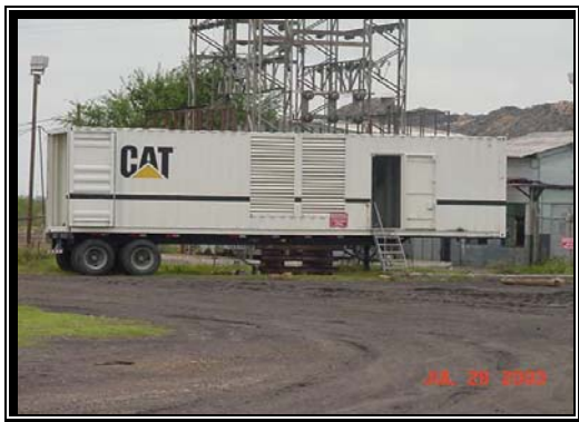
Fotografía 6.34. Estación de Mina III - MIMOSA en el exterior.
