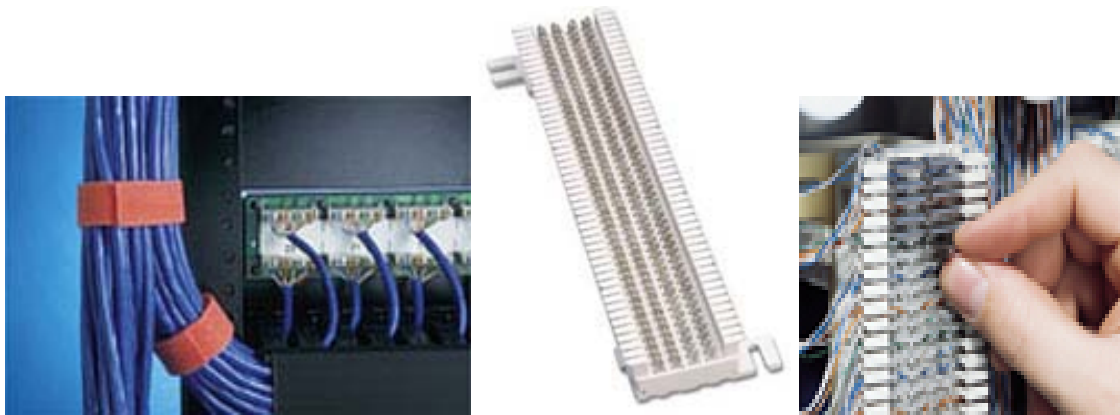
Figura 2.31. Tableros de conexión, regletas telefónicas y jumpers.
