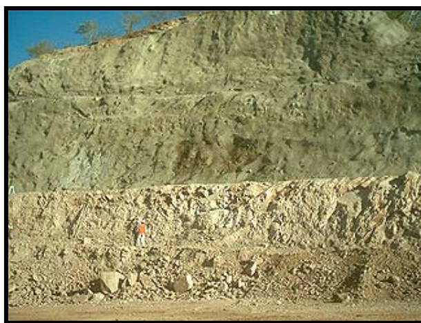
Fig.III.65.-Anclaje en talud canal de llamada. Nótese la capa de concreto lanzado
