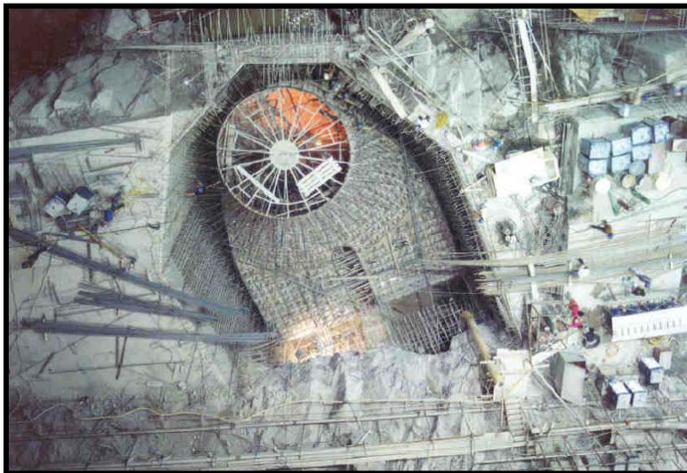
Fig.III.102.-Vista superior del tubo de aspiración
