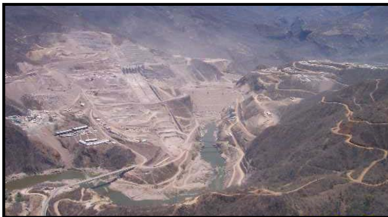
Fig.I.16.- Vista aérea de la zona de obras del PH El Cajón al 6 de abril 2005
