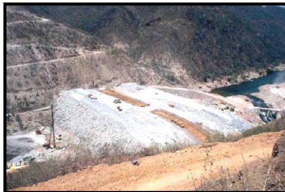
Fig.III.14 Ataguía de aguas arriba en proceso de construcción, formada con materiales graduados y corazón impermeable de arcilla
