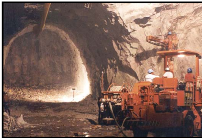
Fig.III.87.-Barrenación para anclaje en las paredes de la caverna. Al fondo se nota el túnel auxiliar al tímpano norte de la casa de máquinas
