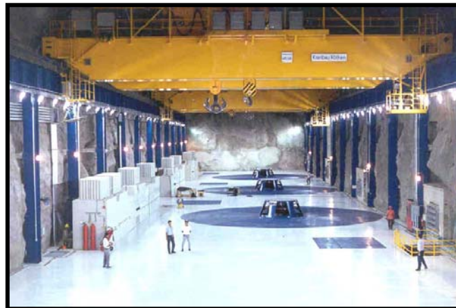
Fig. III.110.-Vista general de casa de máquinas
