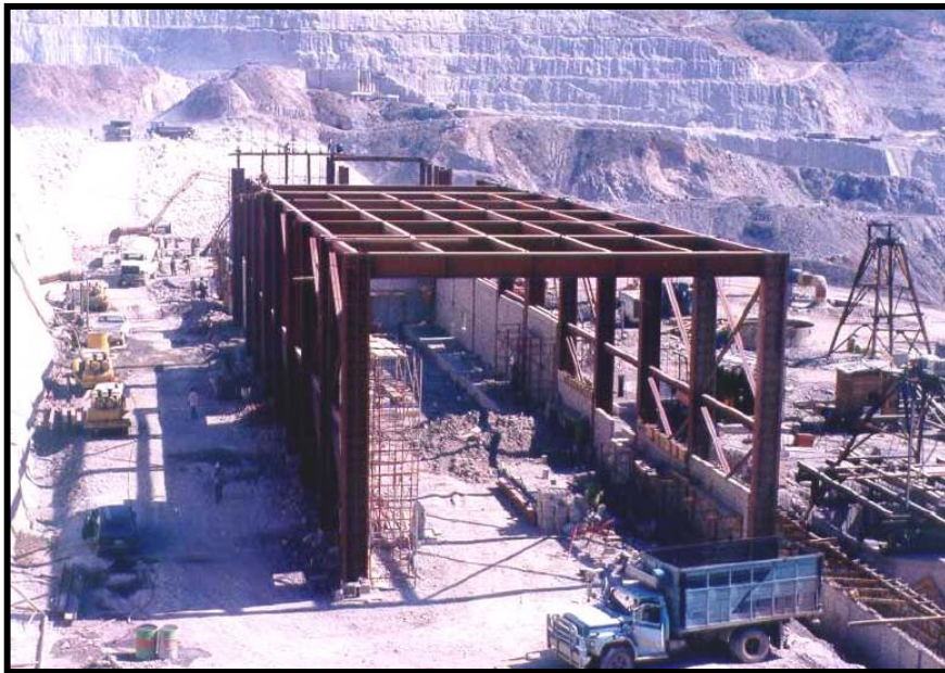
Fig.III.54.-Estructura metálica en edificio de 400 kV de la subestación
