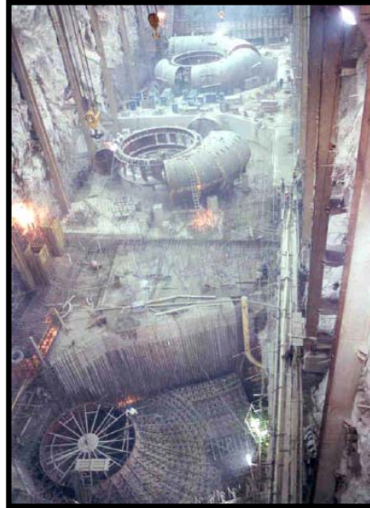
Fig.III.105.-Vista general de casa de máquinas, obsérvese el tubo de aspiración en una unidad, la carcasa-antedistribuidor en otra, y al fondo la carcasa espiralantedistribuidor
