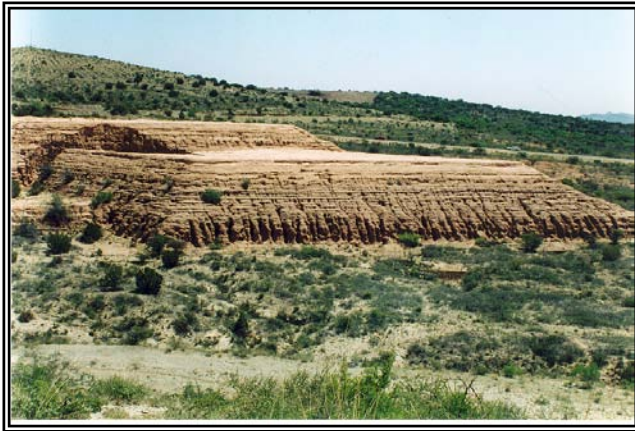
Figura 45. Vista general de la presa en donde se observa una clara erosión pluvial, originada por el escurrimiento de agua por las laderas, también se puede observar el desprendimiento de una parte de la presa debido al agua
