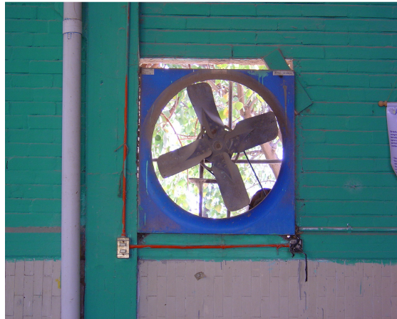
Figura 6. Ventilador en recepción de materia prima
