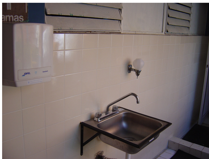
Figura 8. Lavamanos en la entrada a la planta
